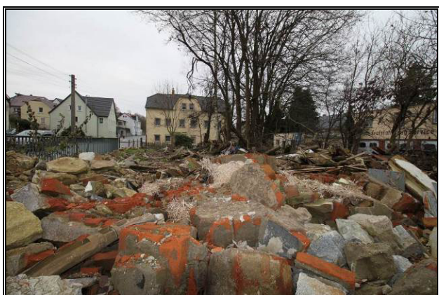
Detailansicht des zu beräumenden Bauschutts (West-Ansicht)
