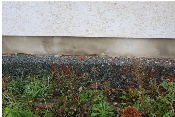
Detailansicht der Feuchtigkeitsschäden im Sockelbereich
