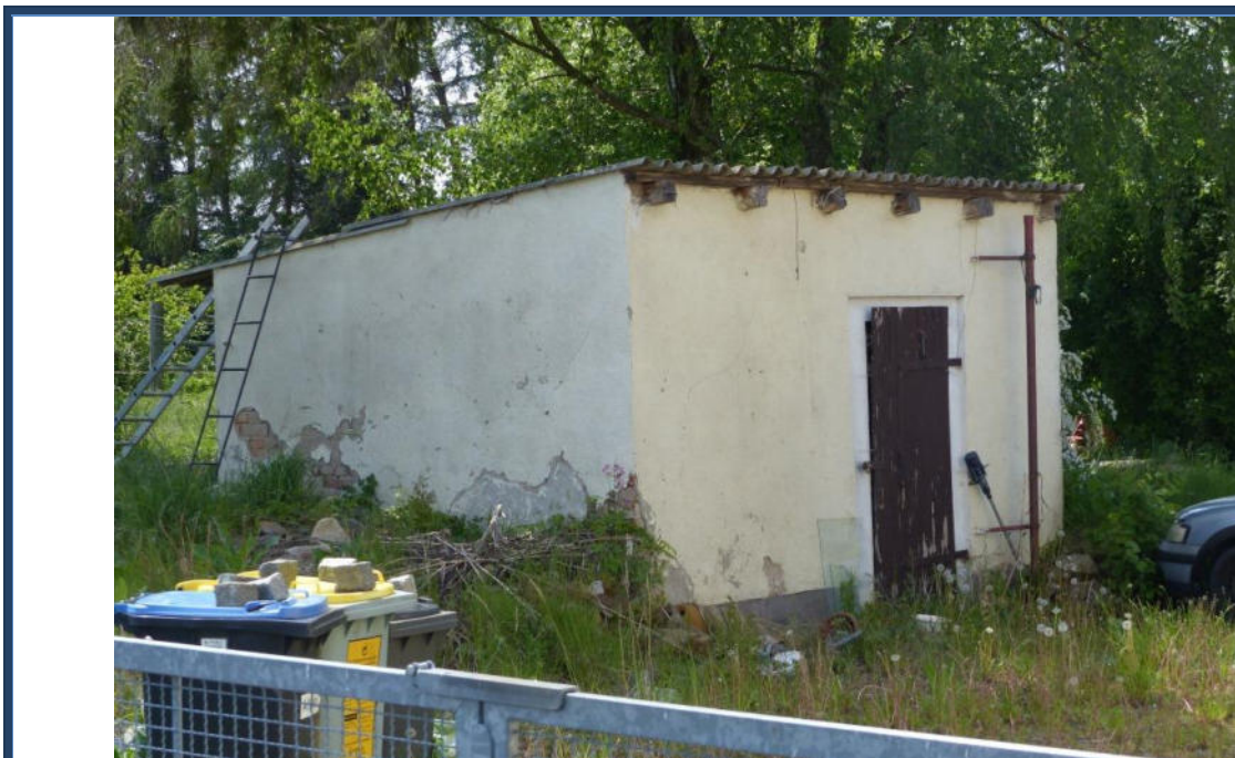
Abbildung 12: Massiver Abstellschuppen; verwilderte und beschädigte Außenanlagen; Unratlagerungen
