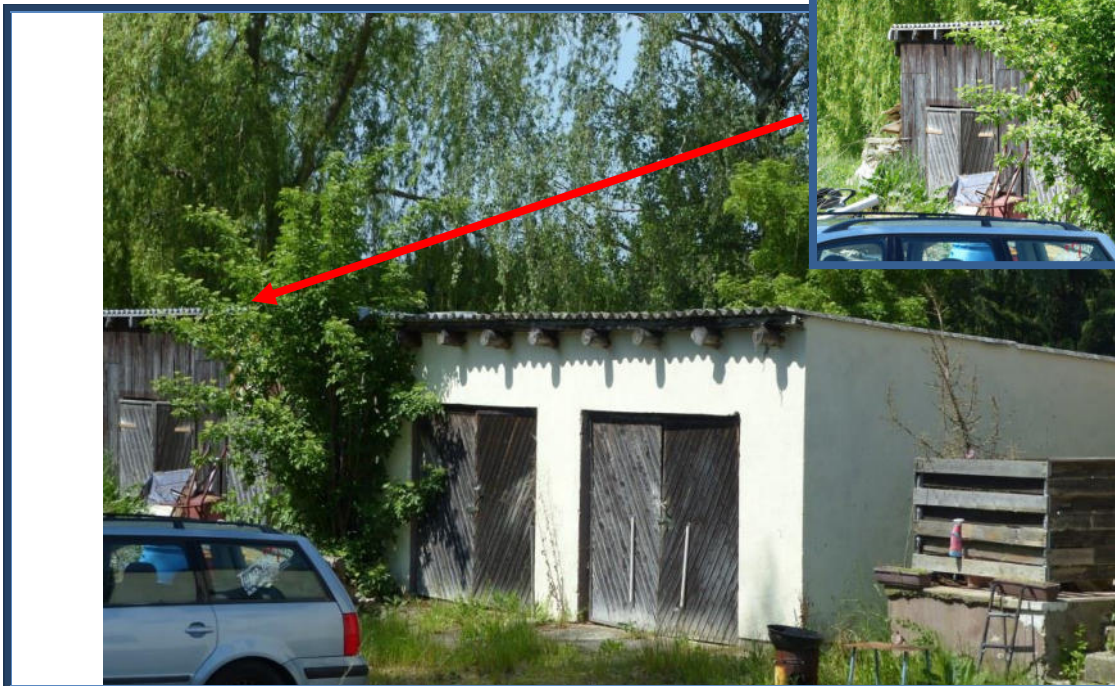
Abbildung 11: Massive Doppelgarage; links der angebaute einfache Abstellschuppen/Garage o. ä. auf Flurstück 1091/2; verwilderte und beschädigte Außenanlagen; Unratlagerungen; ggf. geringfügiger Eigengrenzüberbau durch die Doppelgarage
