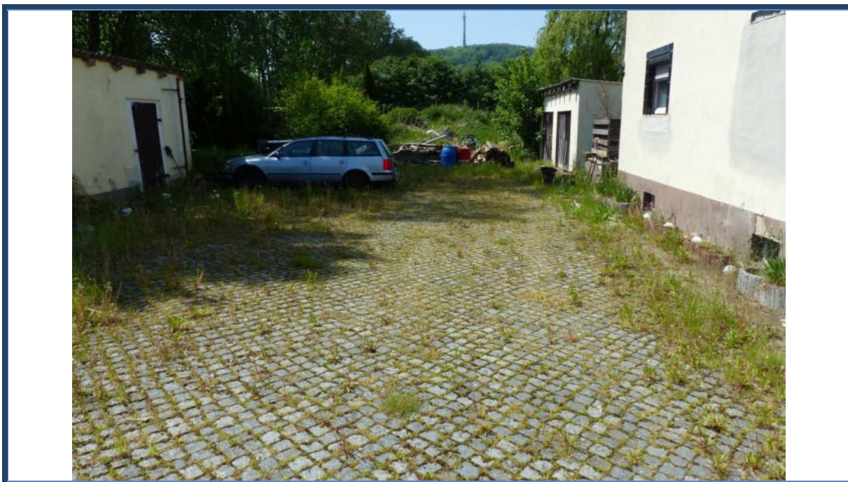
Abbildung 8: Blick in westliche Richtung (Einfahrts-/Eingangsbereich); links der massive Schuppen; rechts die Doppelgarage und das Wohnhaus; verwilderte und beschädigte Außenanlagen; Unratablagerungen; im Hintergrund das Flurstück 1091/2; mittig: ungefährer Verlauf der Zufahrtsbaulast; im Hintergrund der „Löbauer Berg“
