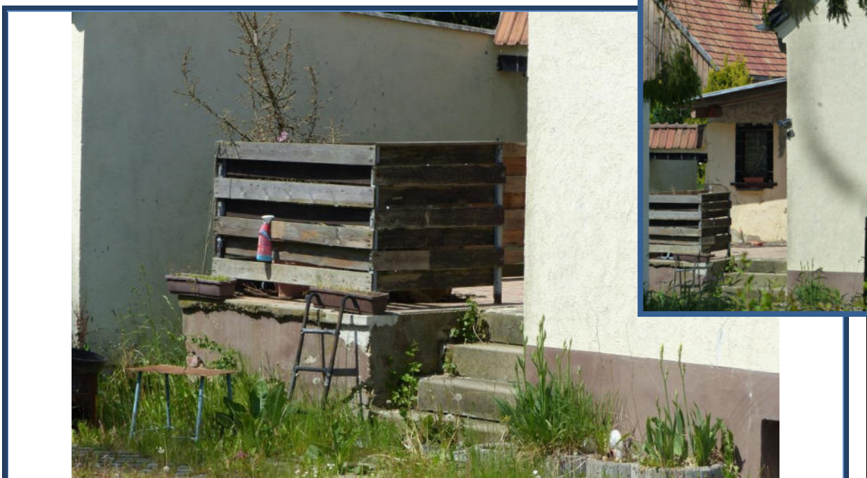
Abbildung 6: Instandsetzungsbedürftiger Eingangsbereich (Eingangsanbau); verwilderte und beschädigte Außenanlagen
