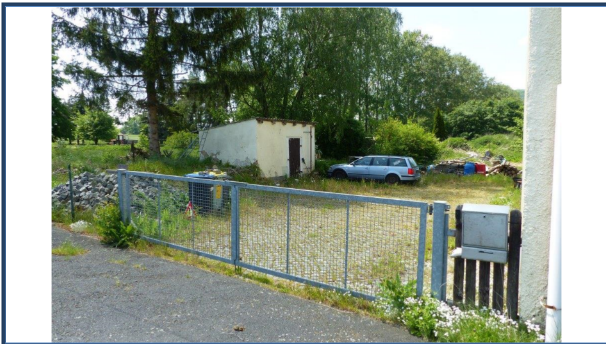
Abbildung 13: Blick in südwestliche Richtung (Einfahrts-/Eingangsbereich); links der massive Schuppen; verwilderte und beschädigte Außenanlagen; Unratlagerungen
