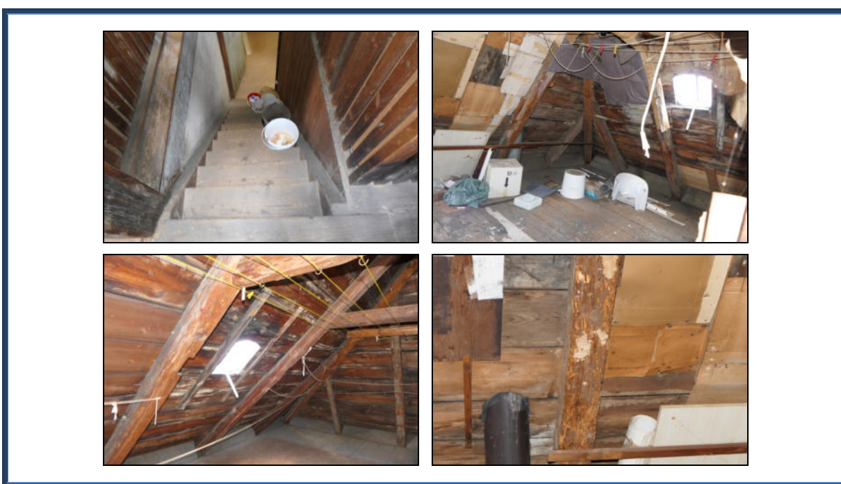
Abbildung 19: Faktorenhaus: Dachboden (Abstellboden); beschädigte Holzbauteile und Dacheindeckung; mehrere Wassereinlaufspuren
