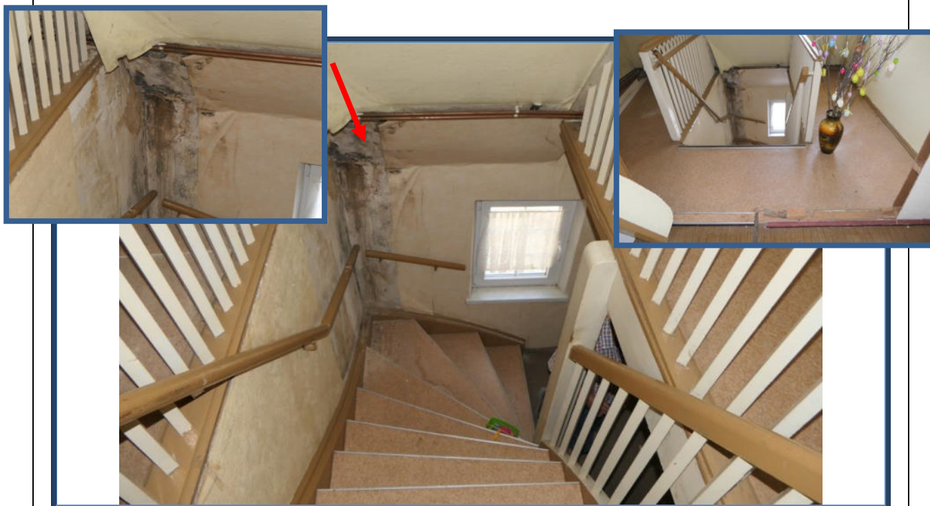
Abbildung 12: Faktorenhaus: Treppe zwischen Ober- und Dachgeschoss; Treppenhaus; erheblicher Feuchtigkeitsschaden durch die beschädigte Dacheindeckung
