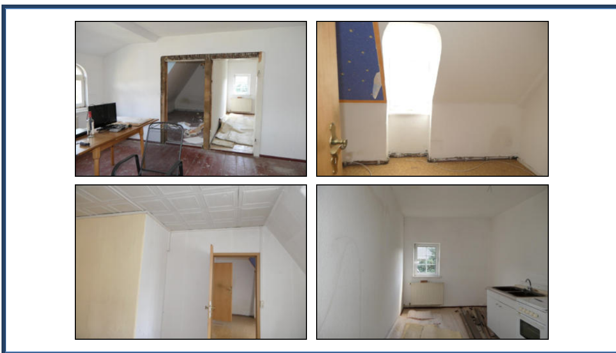
Abbildung 13: Faktorenhaus: Wohnräume im Dachgeschoss; derzeit nicht nutzbar (begonnene Umbau-, Renovierungs- und Sanierungsarbeiten)
