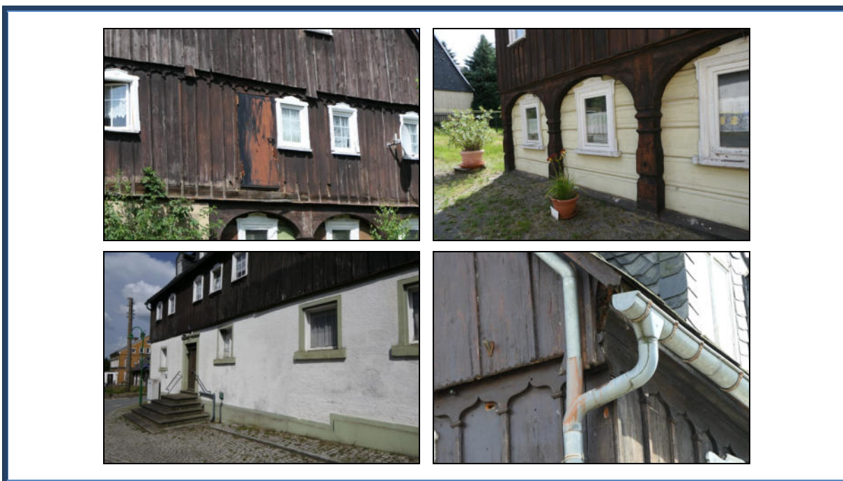
Abbildung 20: Detailansichten der Fassade des Faktorenhauses; Holzbauteile tlw. verwittert bzw. beschädigt
