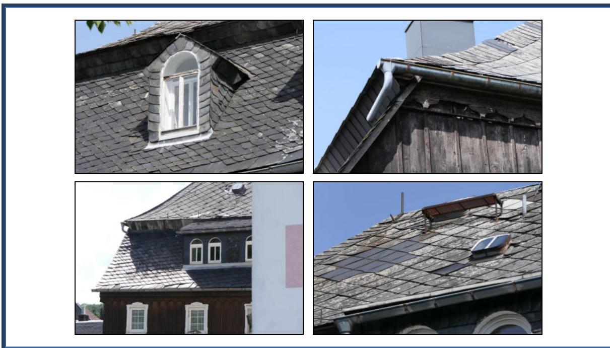
Abbildung 21: Detailansichten der Dacheindeckung des Faktorenhauses; Dacheindeckung tlw. beschädigt
