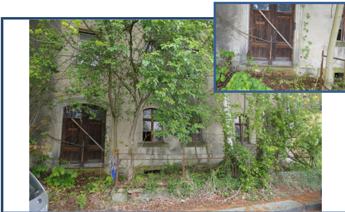
Abbildung 8: Hauseingangsbereich an der Gebäudewestseite (Straßenseite); stark verwilderte und beschädigte Außenanlagen
