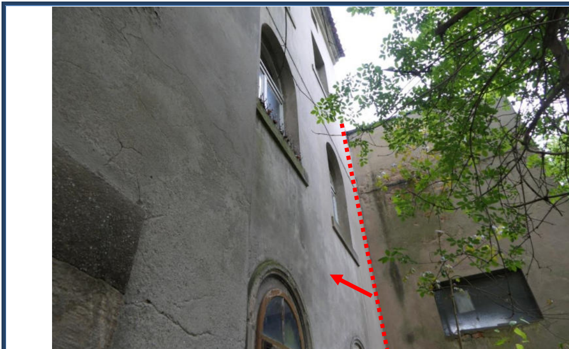
Abbildung 7: Rückansicht (Nord-Ansicht); starke Beschädigungen an der Fassade; angrenzende Bebauung auf Flurstück 1200
