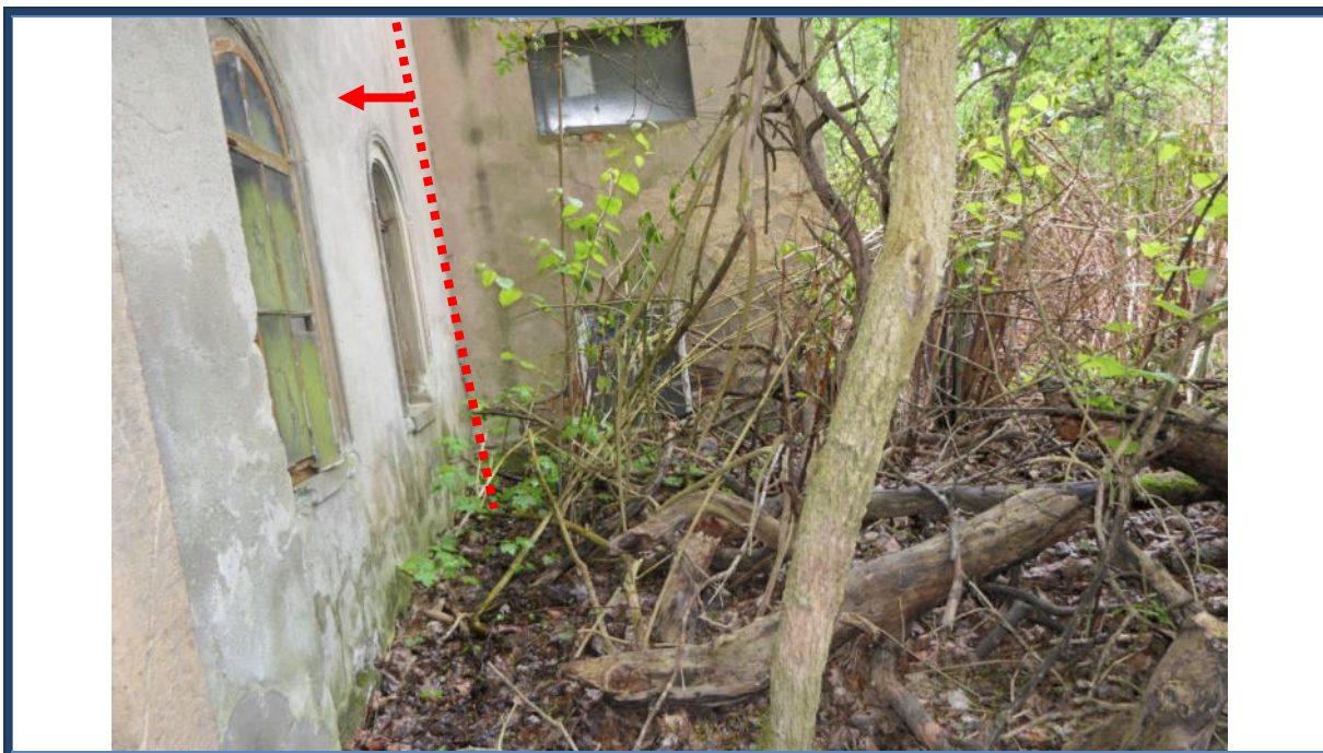
Abbildung 15: Stark verwilderte und beschädigte Außenanlagen im rückseitigen Grundstücksbereich; angrenzende Bebauung auf Flurstück 1200
