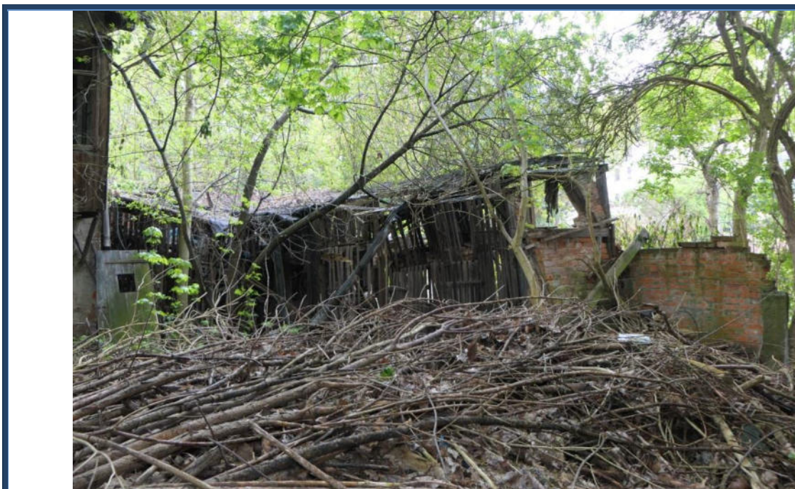
Abbildung 12: Abrissreife ehemalige Schuppen im südöstlichen Grundstücksbereich; stark verwilderte und beschädigte Außenanlagen
