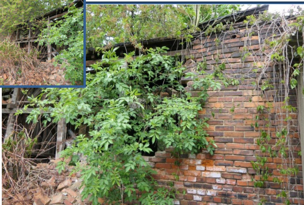
Abbildung 13: Rückansicht des abrisssreifen Schuppens im südöstlichen Grundstücksbereich; stark verwilderte und beschädigte Außenanlagen; Ansicht vom Flurstück 1212 a
