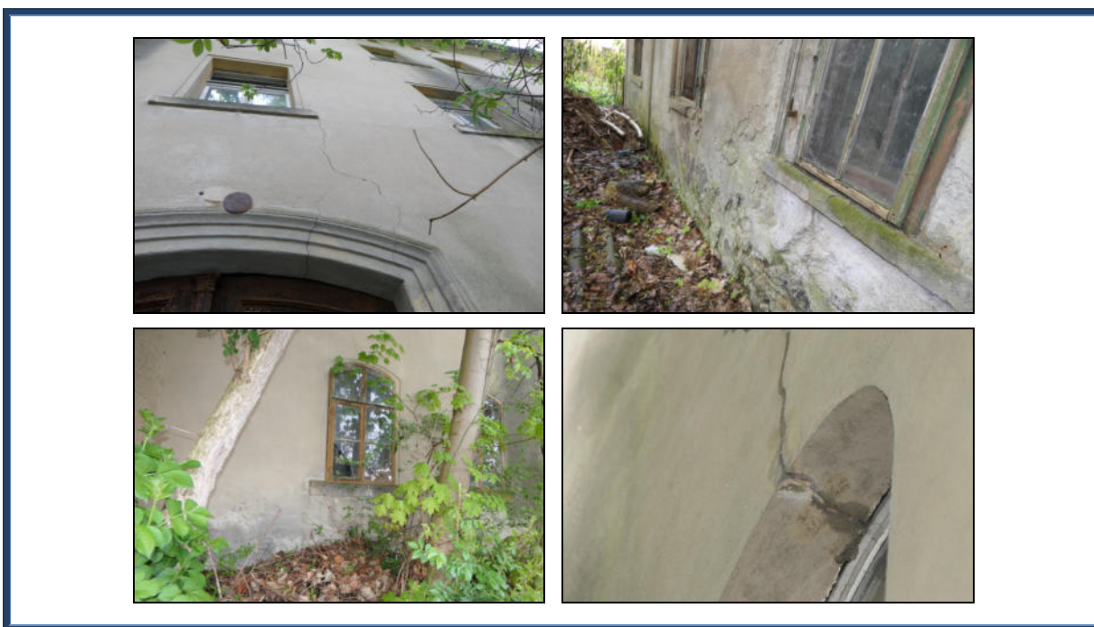
Abbildung 9: Detailansichten: Schäden an der Fassade und den Fenstern; tlw. starke Rissbildung
