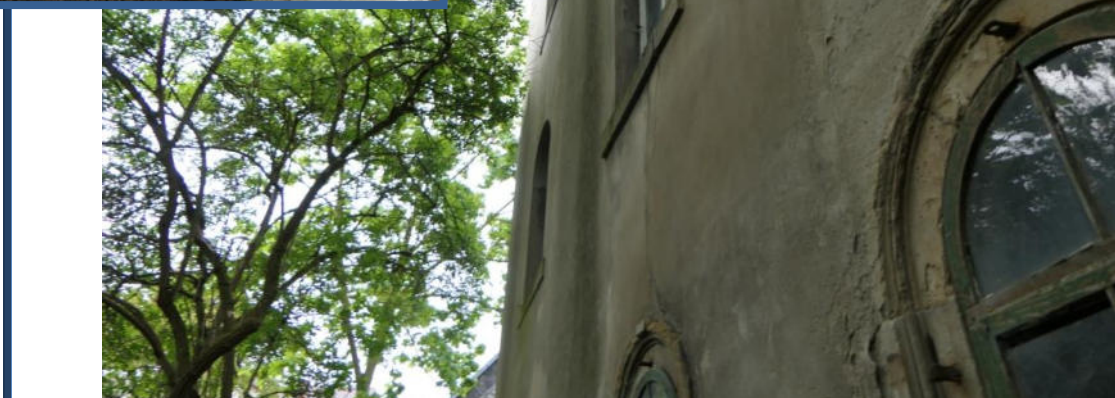
Abbildung 6: Rückansicht (Nord-Ansicht) starke Beschädigungen an der Fassade; stark verwilderte und beschädigte Außenanlagen; umliegende Bebauung
