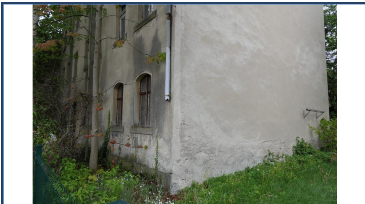
Abbildung 4: Seiten- und Vorderansicht (Süd-West-Ansicht); starke Beschädigungen an der Fassade und der Dachentwässerung; stark verwilderte Außenanlagen; im Vordergrund das benachbarte Flurstück 1201
