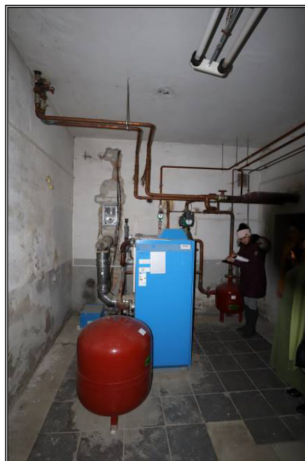
Heizung im Kellergeschoss
