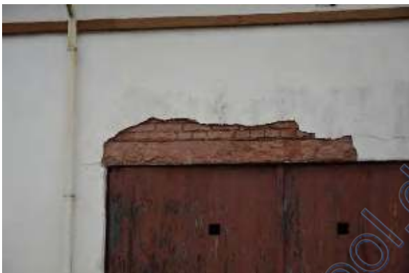
Fassade mit Putzschäden
