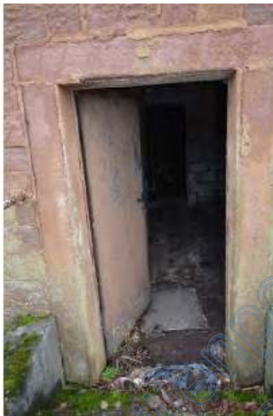
Zugang Kellergeschoss (korrodierte Eingangstür)
