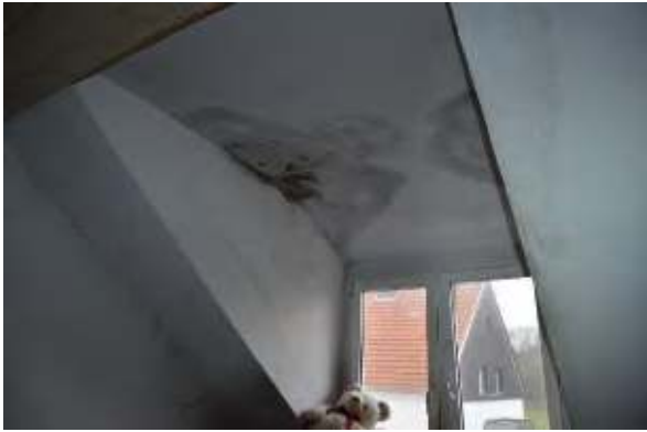
Gaube mit Feuchtigkeitsschaden und Schimmelbildung
