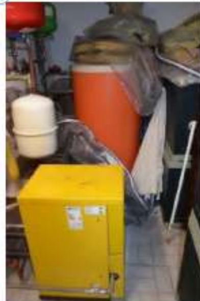
Wärmeerzeuger und Warmwasserspeicher der Bewertungseinheit
