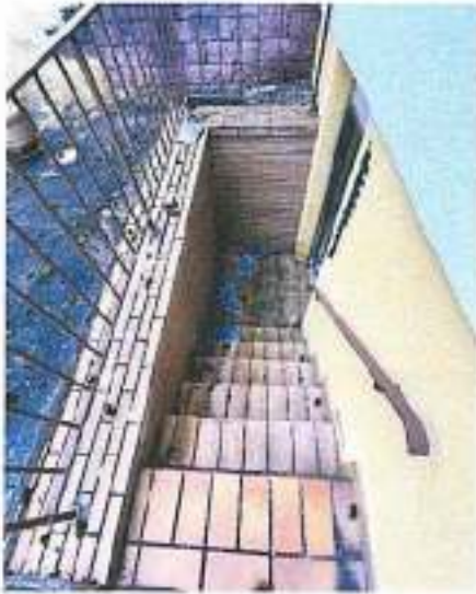
Kellerausstentreppe mit Feuchte/Belagschäden
