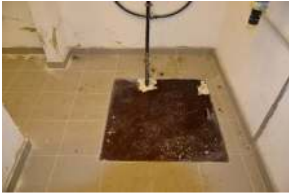
Hebeanlage im KG
