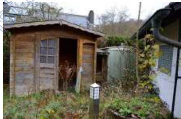
Gartenhaus mit schadhaften Türen
