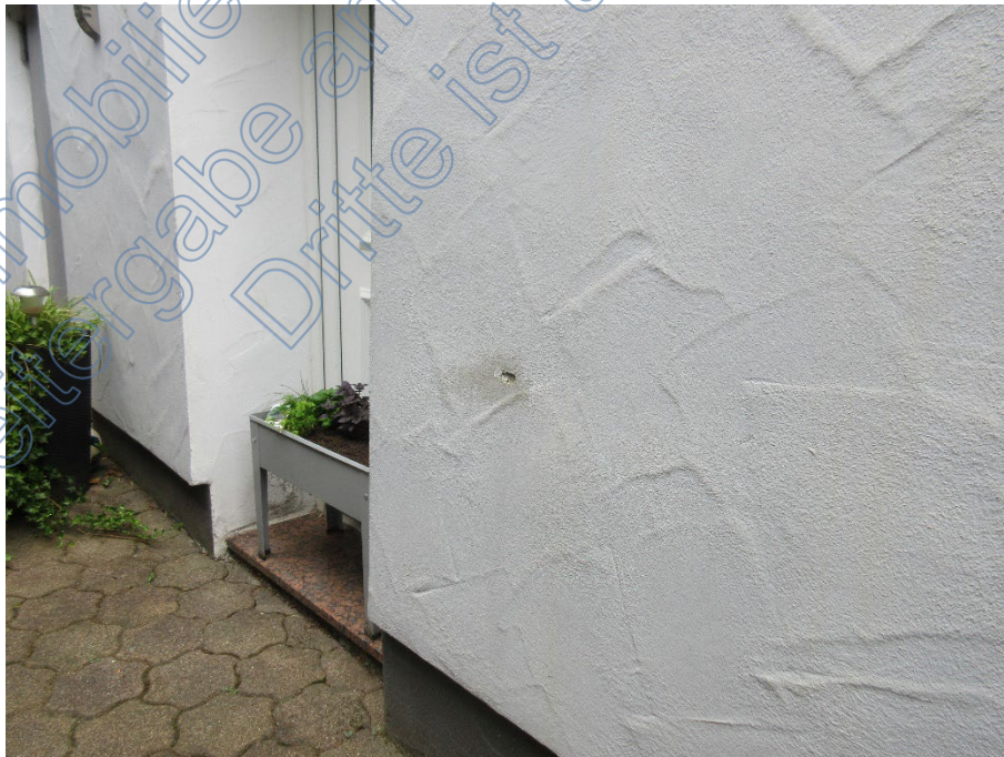
Foto 4 – Fassadenausschnitt Westfassade – lokaler Putzschaden
