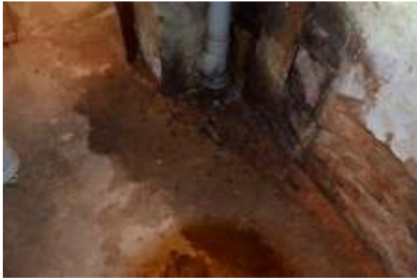
Putz- und Feuchtigkeitsschäden im Kellergeschoss exemplarisch
