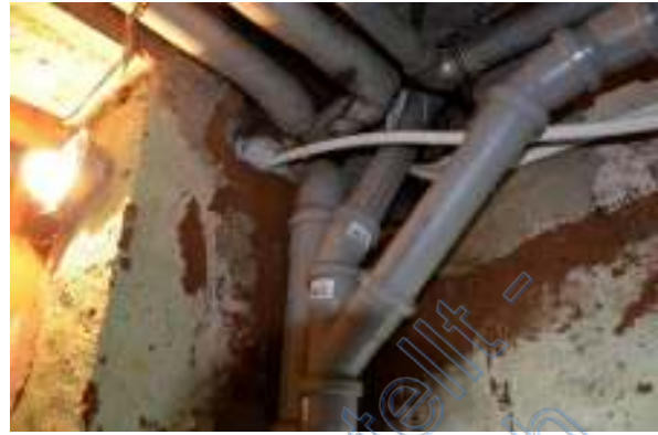
Leckage an Wasserleitung
