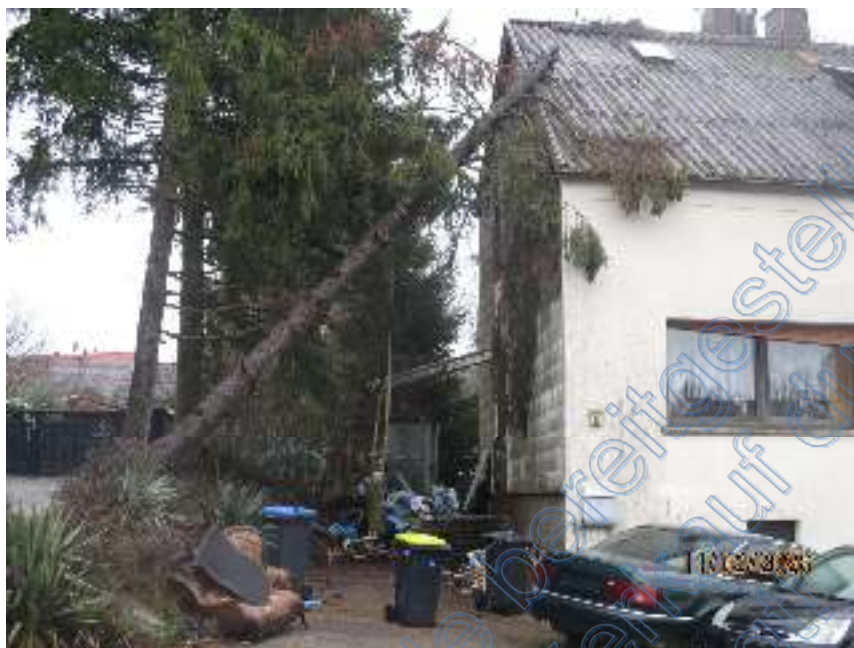
Bild 5: Schaden am Dach
