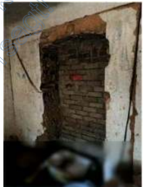
Nicht fertig gestellte Arbeiten
