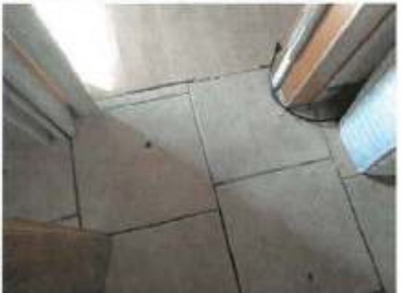
lokal fehlende Abdeckleisten am Bodenbelag
