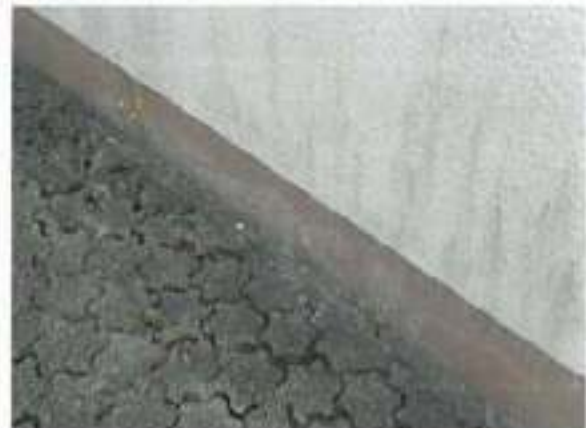
Beispiel Renovierungsbedarf Fassaden
