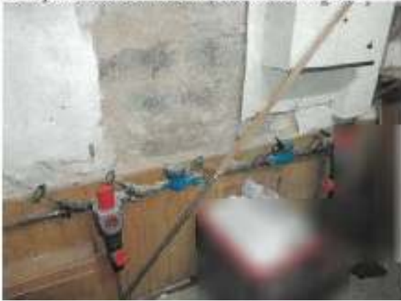
Beispiel lokaler Feuchteschäden im UG
