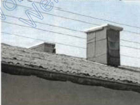
Eternitprodukte vermutlich asbesthaltig
