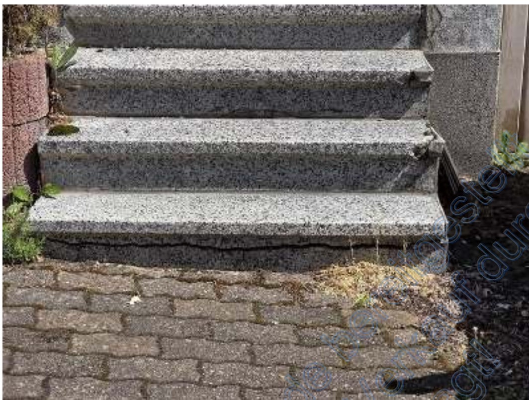
Bild 9 - Risse und Setzungen an den Stufen der Eingangstreppe
