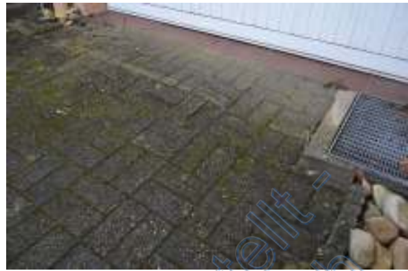
abgesackte Pflasterfläche in Garagenzufahrt links
