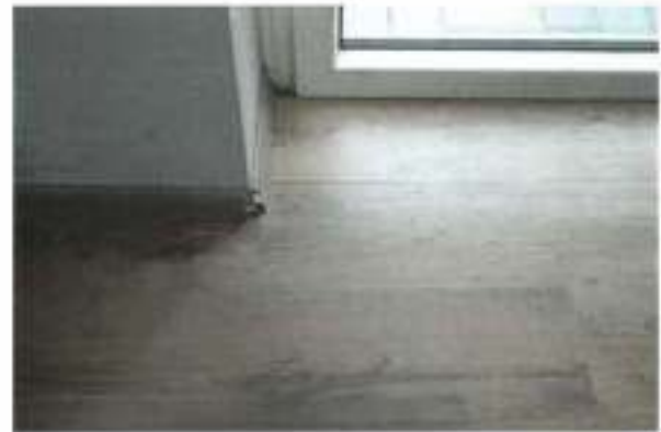
schleifendes Fenster im EG
