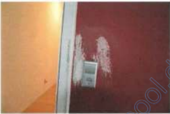
Schäden an Wand
