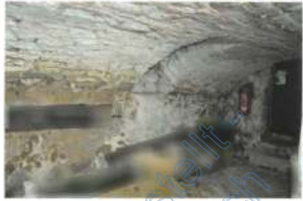
Gewölbekeller mit Putz- und Feuchtigkeitsschäden
