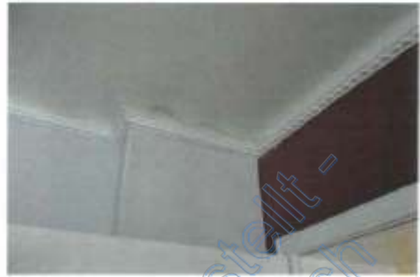
Feuchtigkeitsbilder an Decke im OG
