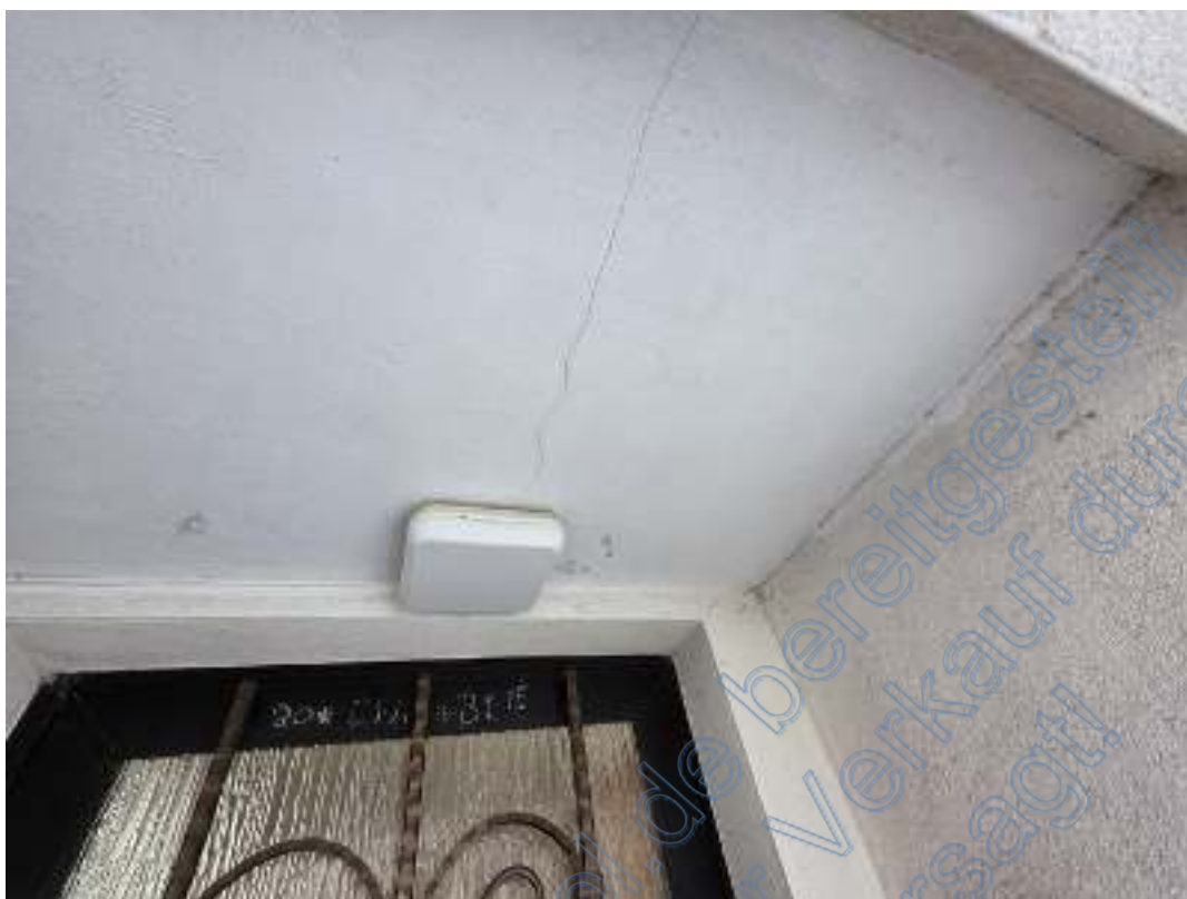
Bild 11 - Setz- und Putzrisse
