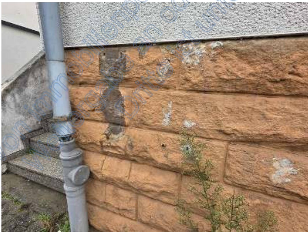
Bild 12 - Putzabblätterungen (1) und defekte Regenrinne
