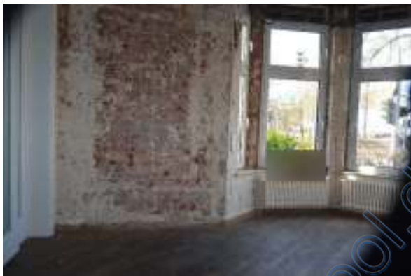
fehlender Putz in Büro 2
