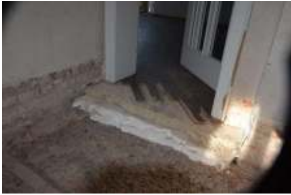
fehlender Estrich und Bodenbelag in Diele
