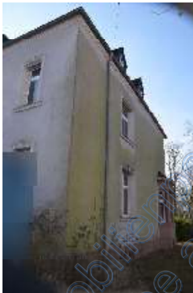
Seitenansicht – Fassade verfarbt und verschmutzt
