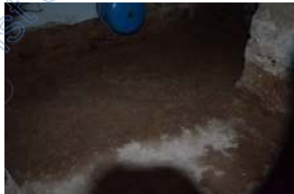
aufsteigende Feuchtigkeit im KG
