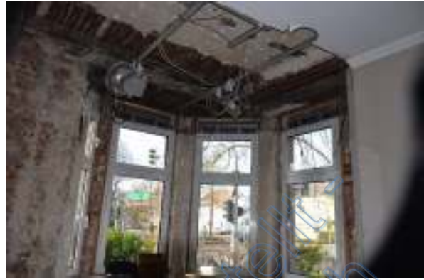
fehlende Deckenbekleidung in Büro 2
