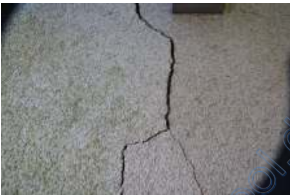
weitere Rissbildung an Garage
