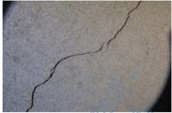
Rissbildung an Garage
