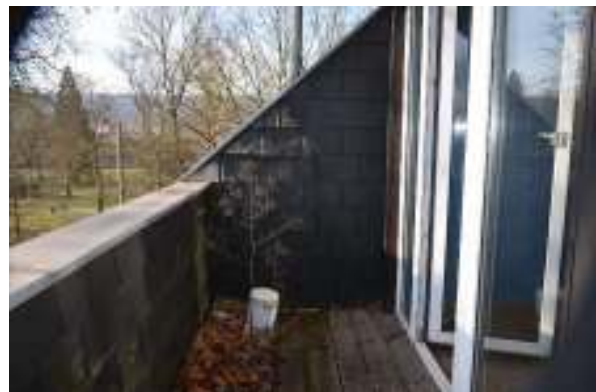
Balkon mit schadhaftem Belag
