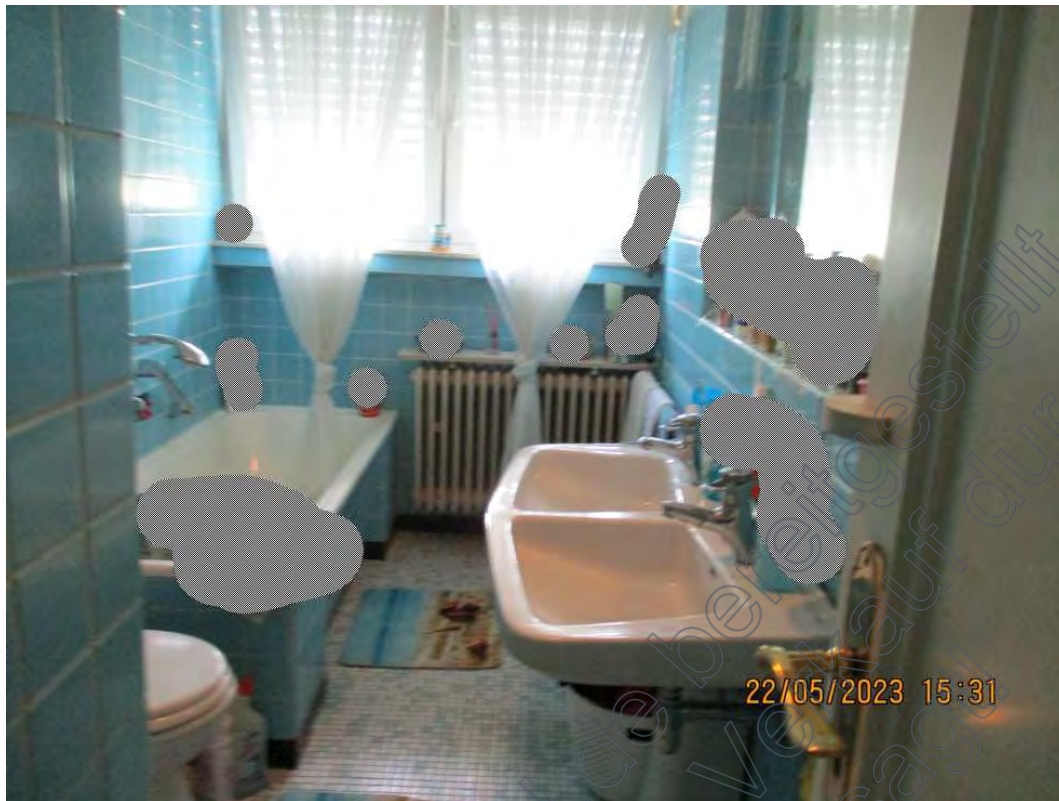
5.9 EG: Badezimmer, Risse im Waschbecken, Übersicht
