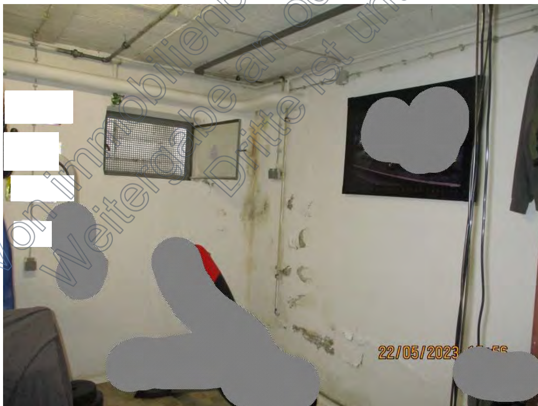
5.24 UG: Feuchtigkeit an den erdberührenden Außenwänden, undichte Kellerwand, defektes Regenrohr, Beispiel
