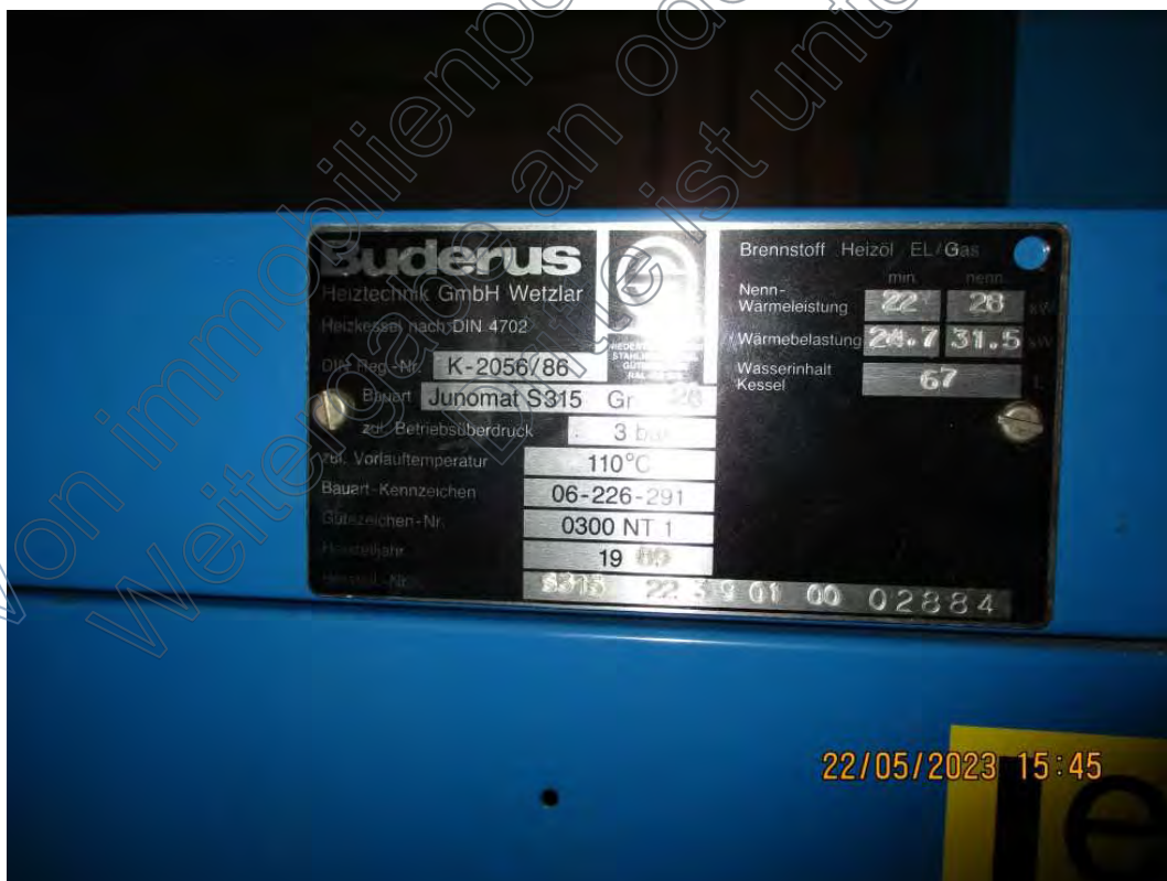
5.6 Heizkessel, Typenschild, Übersicht
