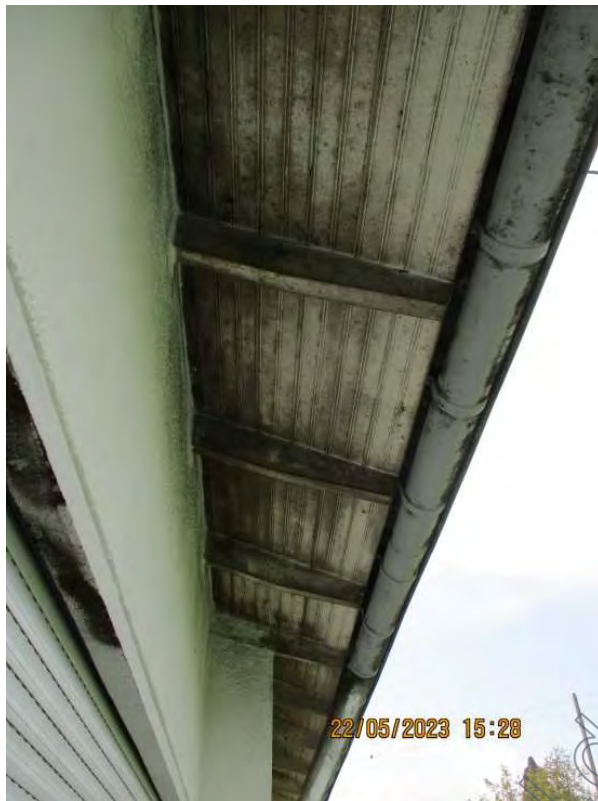
5.19 Feuchtigkeitsschäden a. d. Traufe, deutet auf Undichtigkeiten der Dacheindeckung hin
