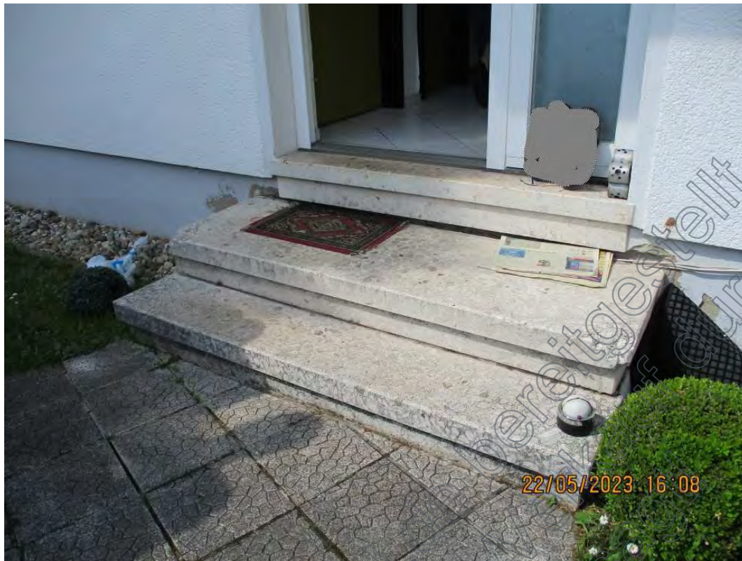
5.17 Schäden, Eingangsstufen haben sich gesetzt, Übersicht
