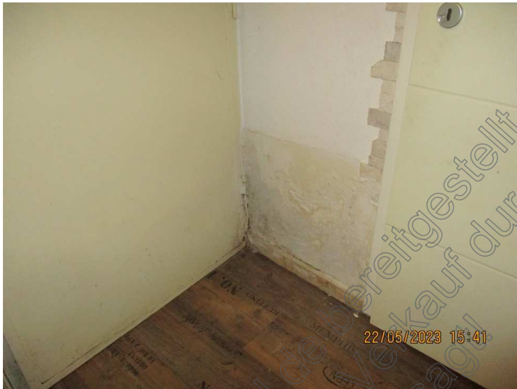
5.23 UG: Feuchtigkeit an den erdberührenden Außenwänden, undichte Kellerwand, Beispiel
