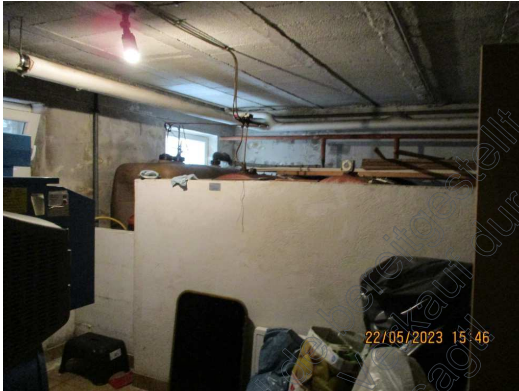
5.7 UG: Heizöltanks, Übersicht
