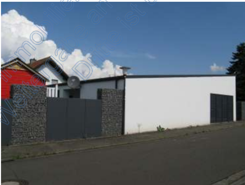
Seitenansicht links, Doppelgarage (fehlende Baugenehmigung)
