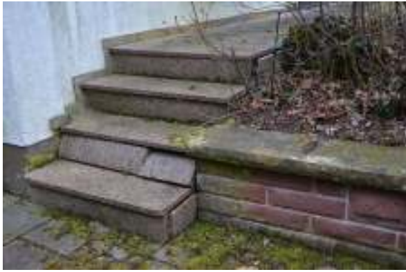
schadhafte Zuwegung bzw. Tritte im Außenbereich exemplarisch
