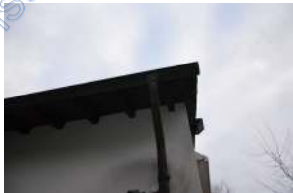
Fassade verschmutzt und verfärbt sowie Rissbildungen
