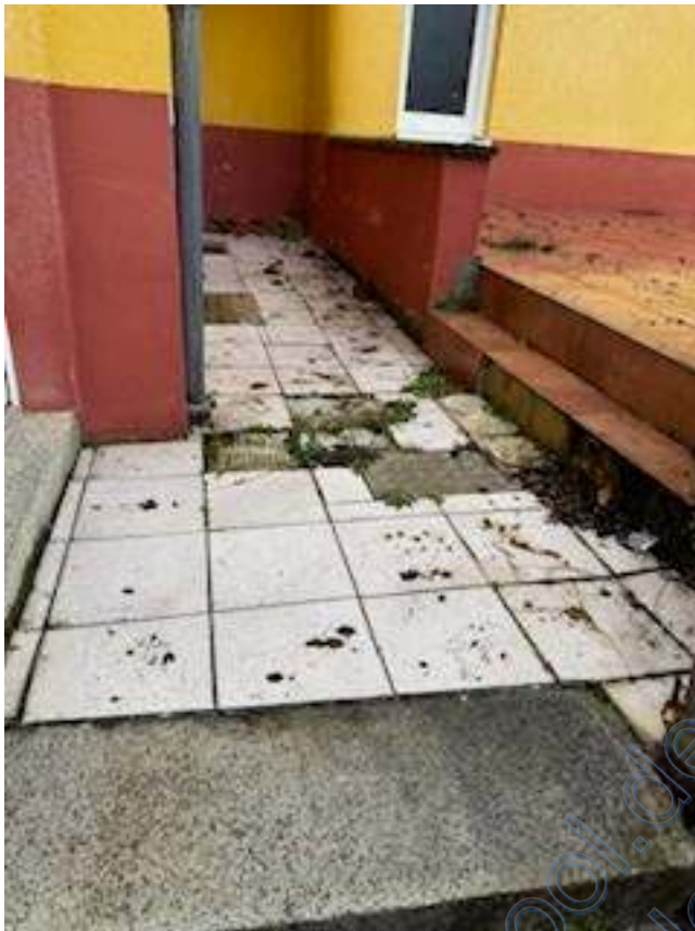
Beethovenplatz, Eingangsbereich, Schäden am Fliesenbelag
