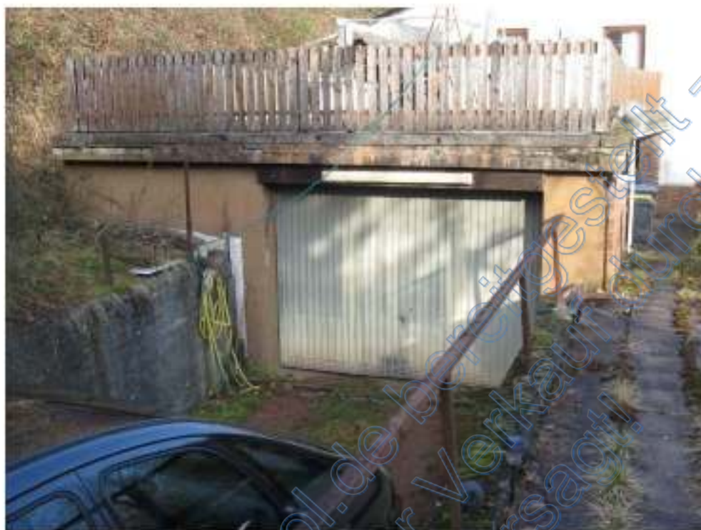
Garage Anbau (Randabschluss Dach schadhaft)
