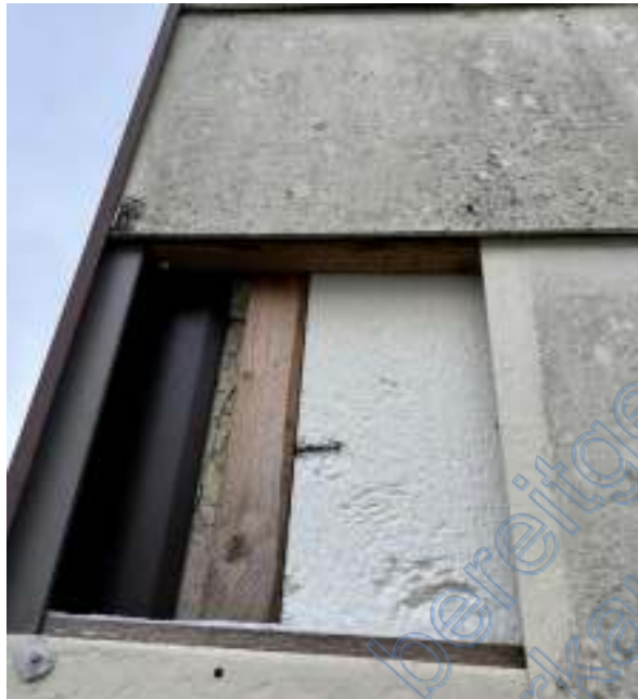
Detail Fassadenverkleidung Süd und West, dünne Styropordämmung sichtbar
