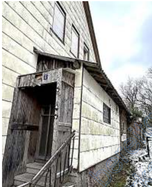
Anbau Windfang ohne Katastereintrag, schlechter baulicher Zustand, Sanierung unterstellt
