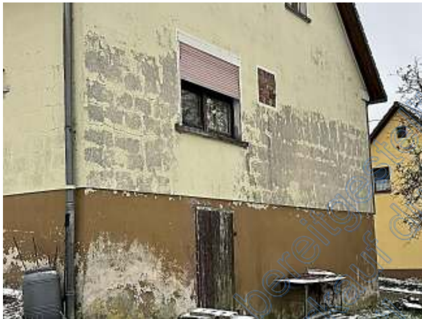
Fassadenschäden Giebel Nord und Kellergeschoss, Fassadensanierung und energetische Modernisierung unterstellt
