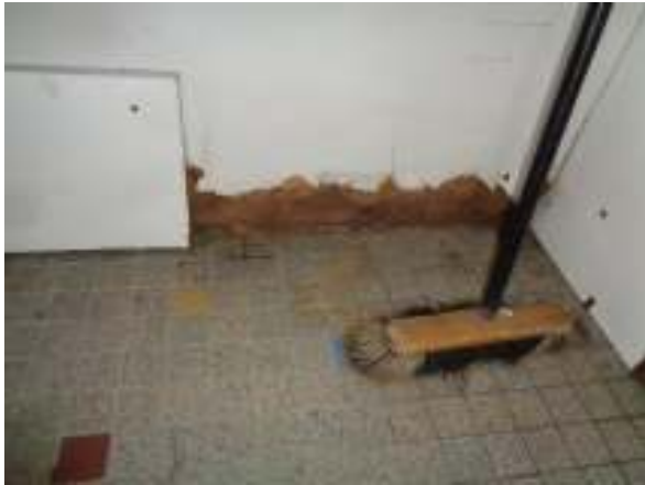
stellenweise Feuchteschäden an Wänden
