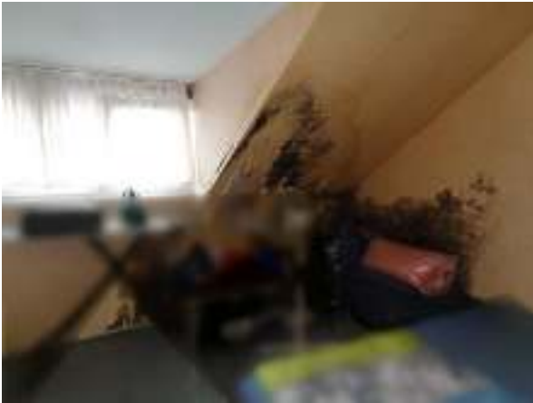
Sehr starker Schimmelbefall
