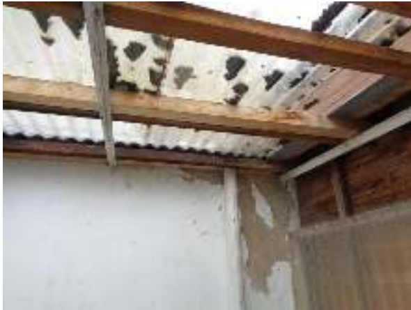
Lokale Feuchteschäden unter dem Dach
