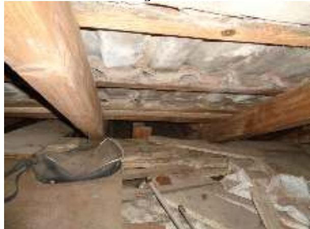
keine Dachdämmung erkennbar
