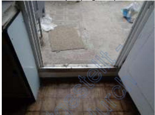
hohe Türschwelle (Stolpergefahr)
