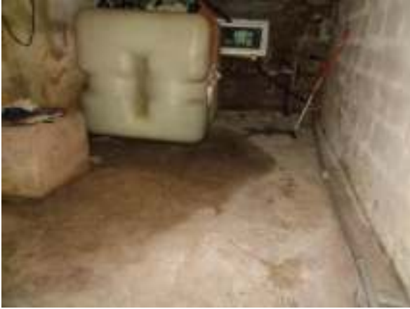
Pfützenspuren; keine Öl-Auffangwanne
