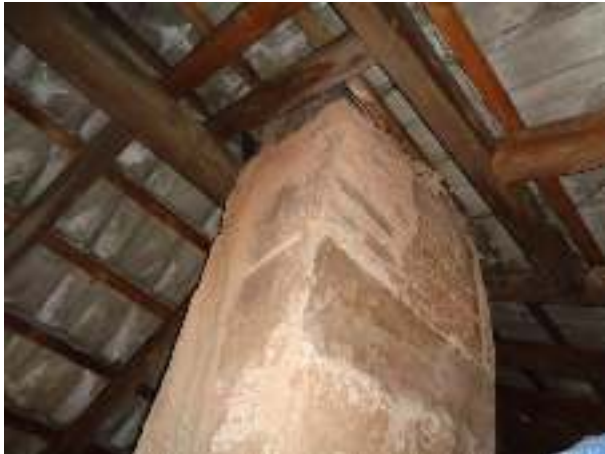
Kamin mit Putz- u. Feuchteschäden
