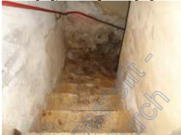
Kellerabgang; zu niedrige Durchgangshöhe
