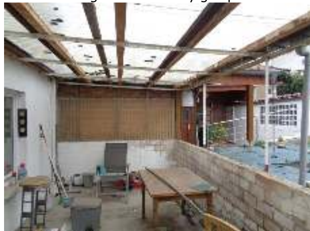
Überdachung aus Well-Acrylglasplatten
