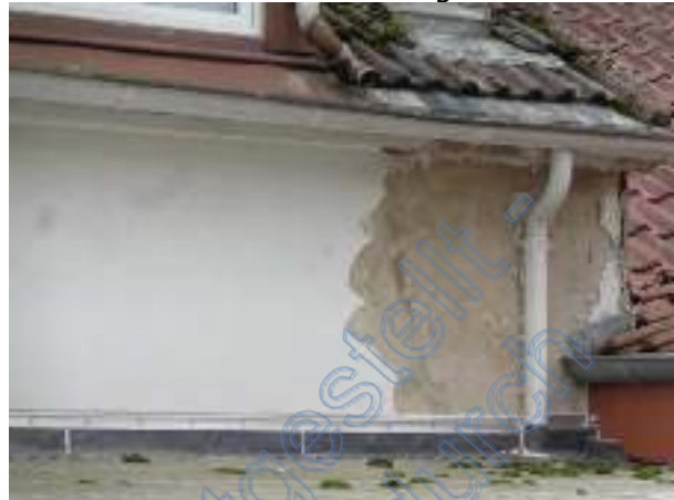
Feuchteschäden unter Dachgesims
