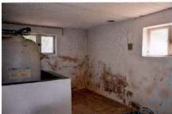
Putz- und Feuchtigkeitsschäden im KG
