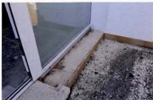
fehlende Abdeckung im Eingangsbereich
