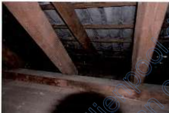
Speicher – oberste Geschossdecke nicht gedämmt
