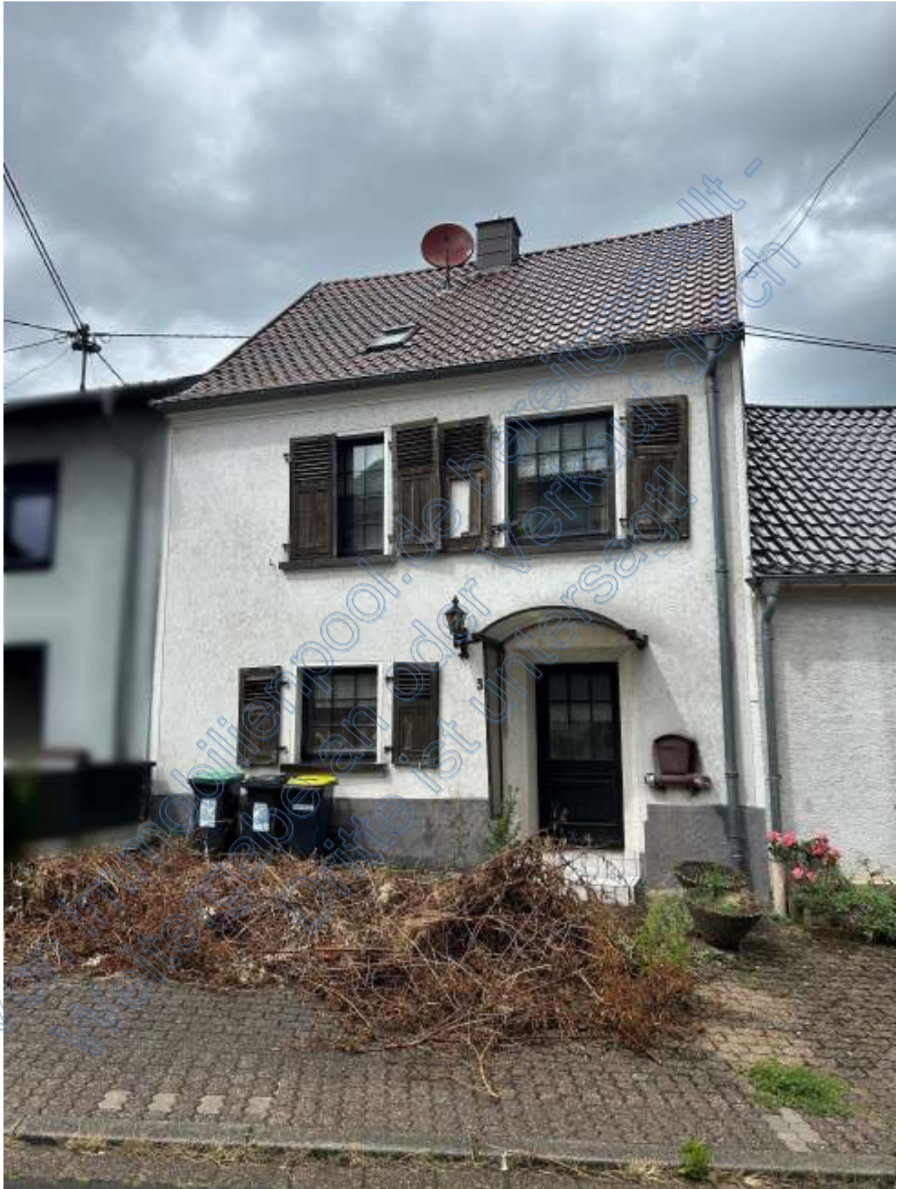
Gebäudefront mit gepflasterter Außenanlage; Verschleiß im Bereich der Fensterläden, der Fenster und der Haustür erkennbar.
