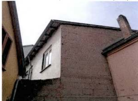
nördlicher Giebel (fehlender Außenputz)
