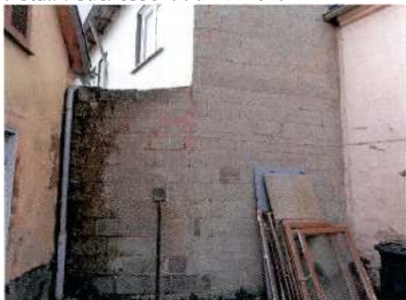
Detail Feuchteschäden an Grenzwand
