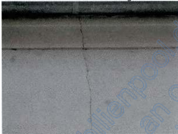
Detail Fassadenriss unter Dachgesims
