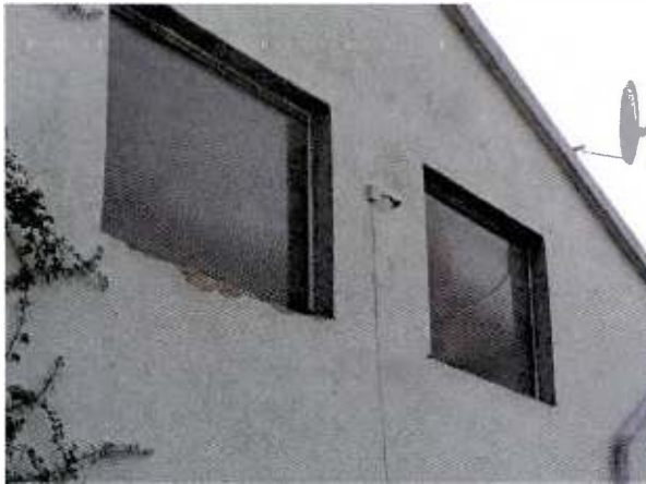
Detail fehlende Fensterbänke
