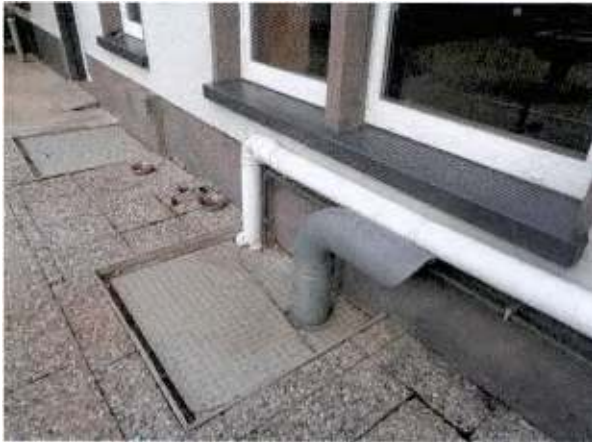
Vermutlich Zuluft für KG-Heizraum
