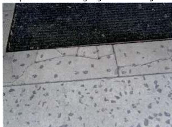
Beispiel Schäden Eingangs-Bodenbelag
