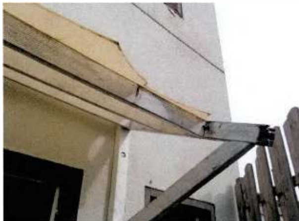
Detail schadhaftes Vordach
