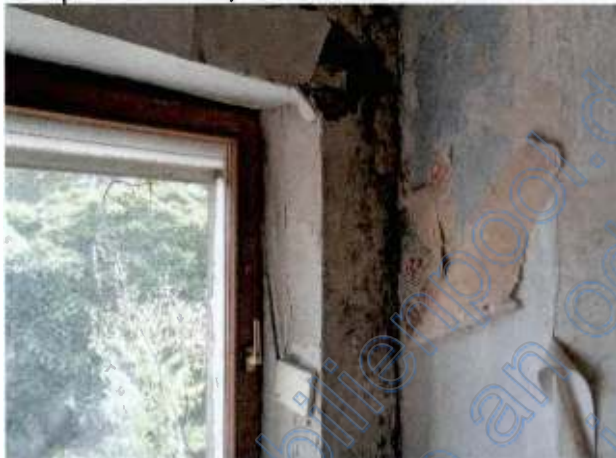
Beispiel Wasser-/ Schimmelschaden
