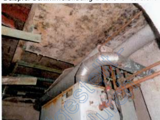
Beispiel Schimmelbildung Deckenuntersicht
