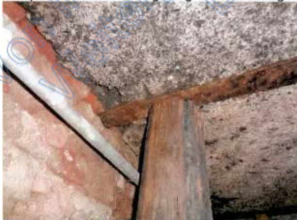
Beispiel nicht mehr tragfähiger Deckenträger
