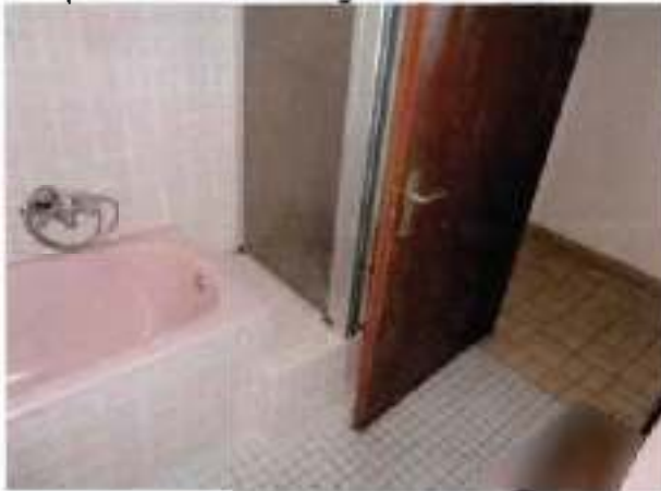
Beispiel Schimmelbelag auf Holztüren
