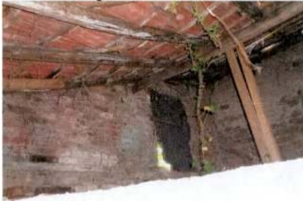
Dach-Einsturzgefahr durch Fäulnissschäden
