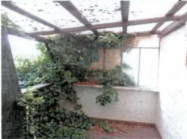
undichter Anschluss Fassade / Überdachung
