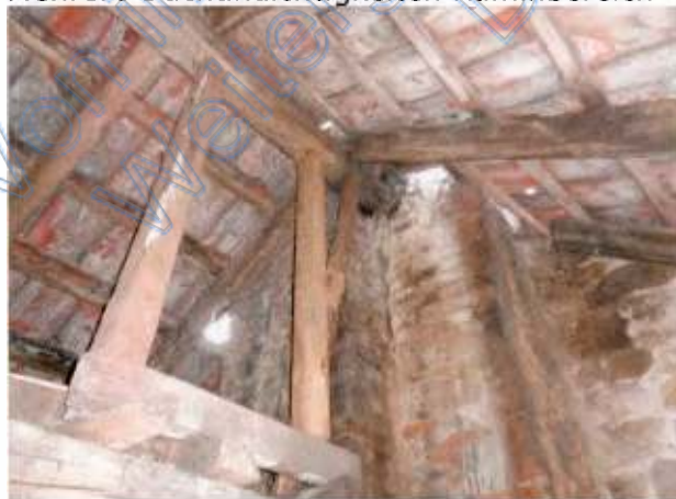
Mehrere Dachundichtigkeiten Kaminbereich
