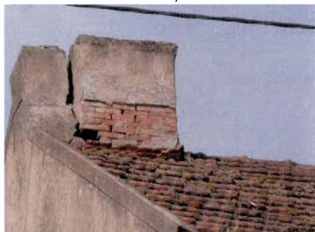
schadhafter Schornstein; undichtes Dach
