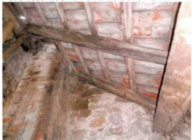
Feuchteschäden an Dachholz und Kamin
