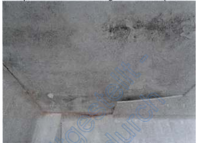
Beispiel Schimmelbildung am Deckenputz
