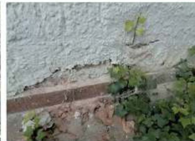
lokale Feuchteschäden an Wänden
