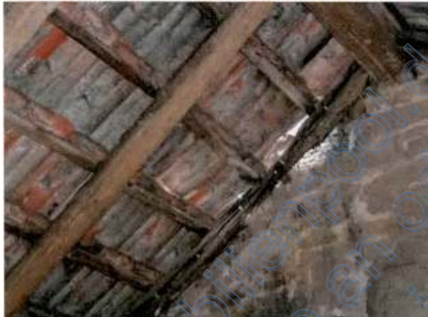
Beispiel lokale Dachundichtigkeiten
