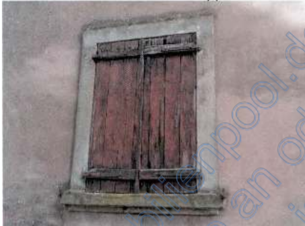
Detail schadhafter Fenster-Klappläden
