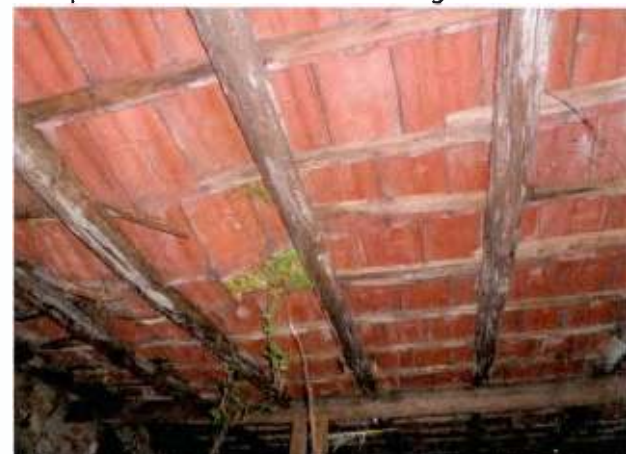
Beispiel lokal fehlende Dachziegel
