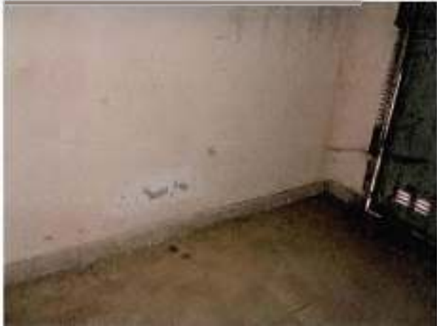
Beispiel Feuchteschäden Innenwände
