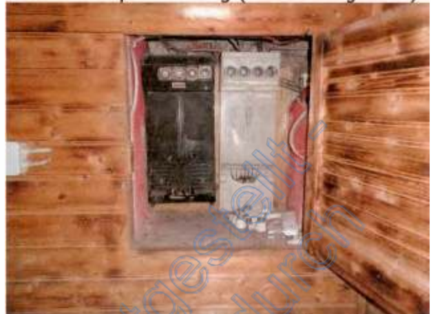
Elektro-Hauptverteilung (Zähler ausgebaut)
