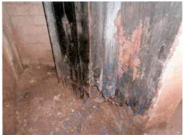
Detail Fäulnissschäden an KG-Holztür
