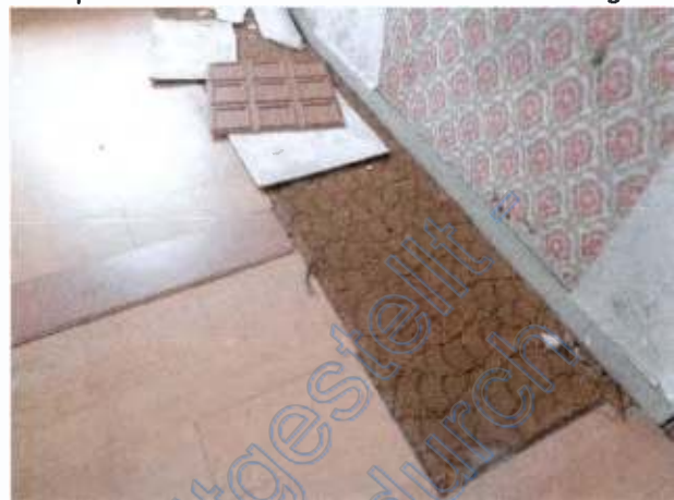
Beispiel schadhafter Laminat-Bodenbelag
