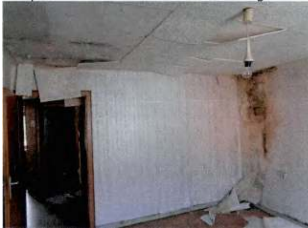
Beispiel schadhafte Deckenverkleidung
