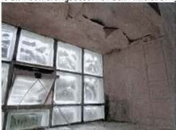
Detail Sanierungsbedarf u. Schimmelbildung
