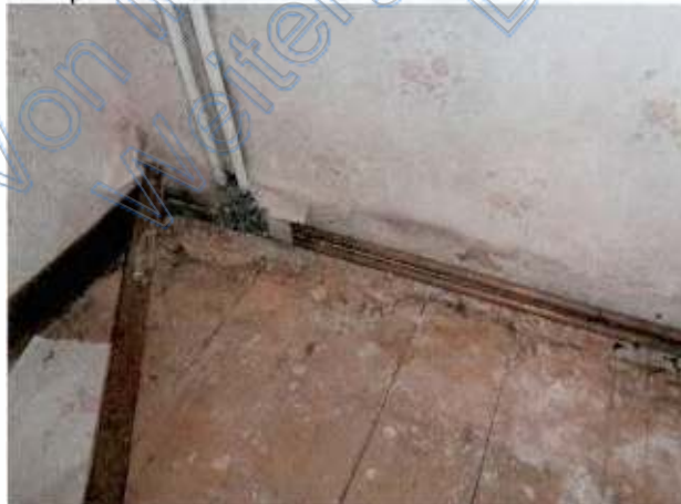
Beispiel Fäulnisschäden an Holz-Bodendielen
