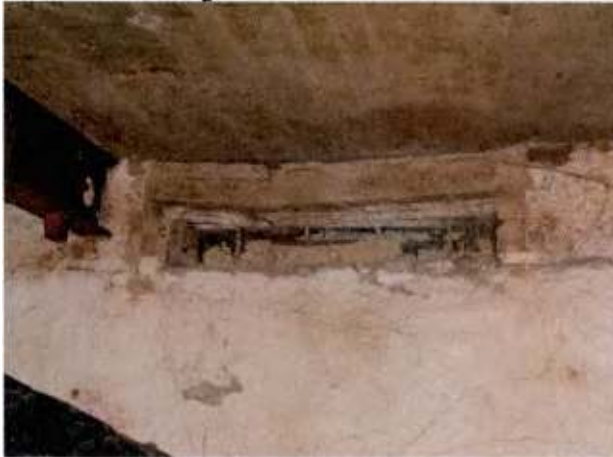
Detail einsturzgefährdeter Holzsturz
