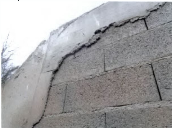
Beispiel überstehende Betonteile
