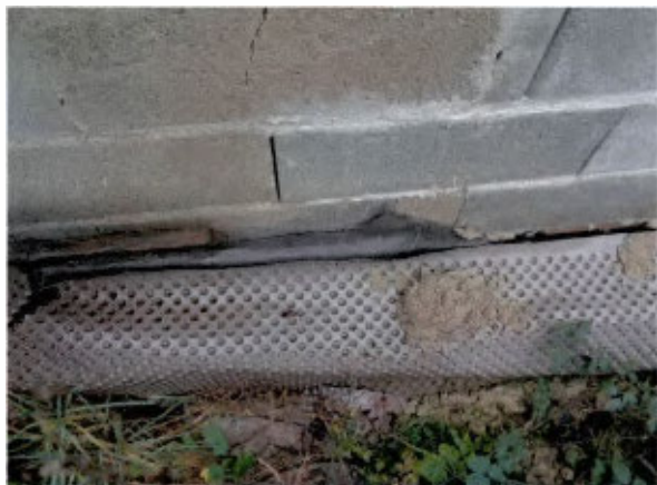
lokale Risse in Mauersteinen
