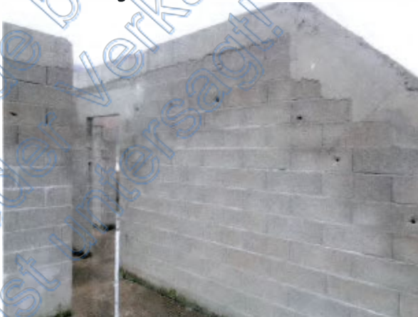
Moosbildung im unteren Wandbereich
