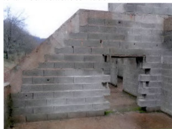
lokal noch fehlendes Mauerwerk
