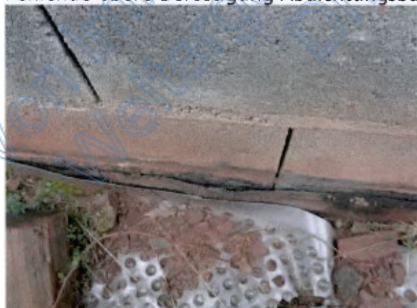
Fehlende obere Befestigung Abdichtungsbahn
