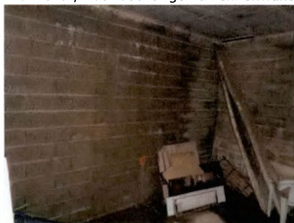
UG-Keller; Auswaschungen an Innenwand
