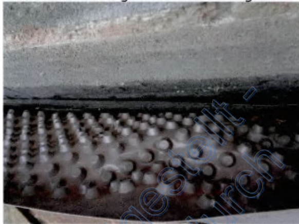
vom Mauerwerk gelöste Abdichtungsbahn
