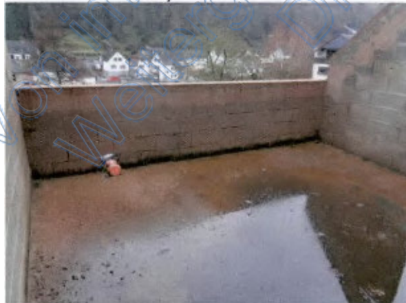
DG-Gästezimmer; tiefe Pfützen
