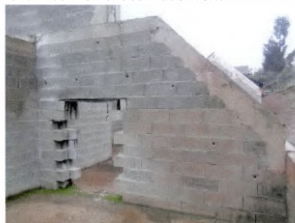
lokal noch fehlendes Mauerwerk
