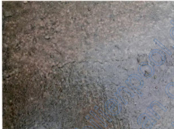
Risse in Oberseite der EG-Betondecke
