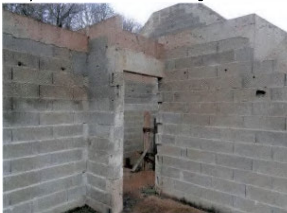
Beispiel fehlender Türanschlag
