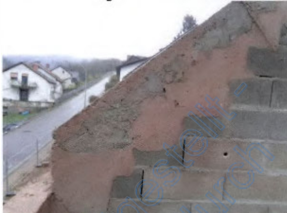
lokal nicht fachgerechte Betonoberfläche
