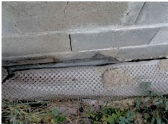
lokale Risse in Mauersteinen
