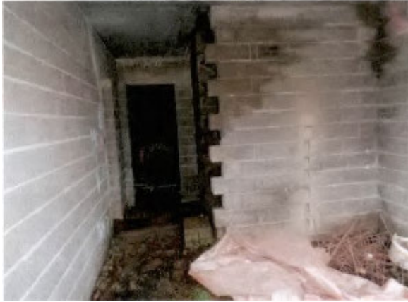
Fehlende Trennwand Diele/ Technikraum
