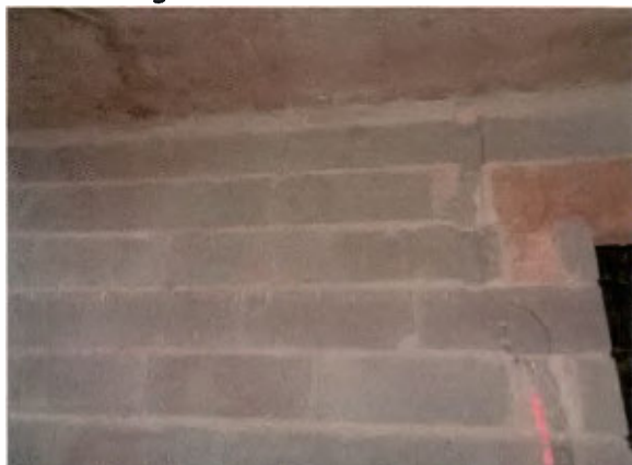
nicht fachgerechte Installationsschlitze
