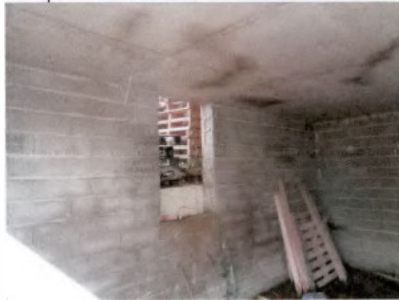
Beispiel durchfeuchtete Wandflächen
