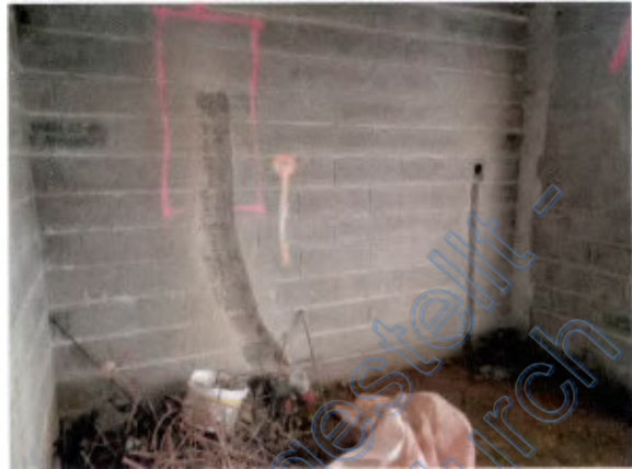
Schlitz in Haustrennwand (Schallbrücke)
