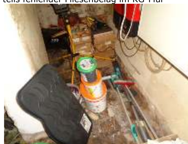
teils fehlender Fliesenbelag im KG-Flur
