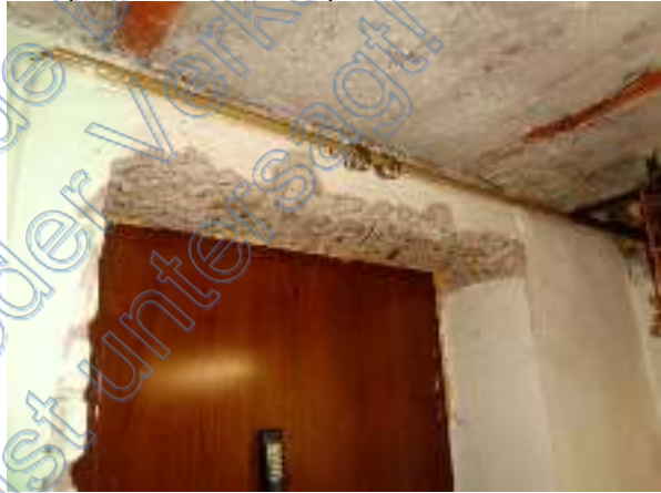
Beispiel fehlender Beiputz an Türsturz
