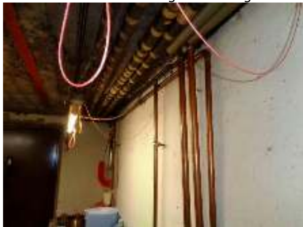
teils fehlende Rohrleitungsdämmung
