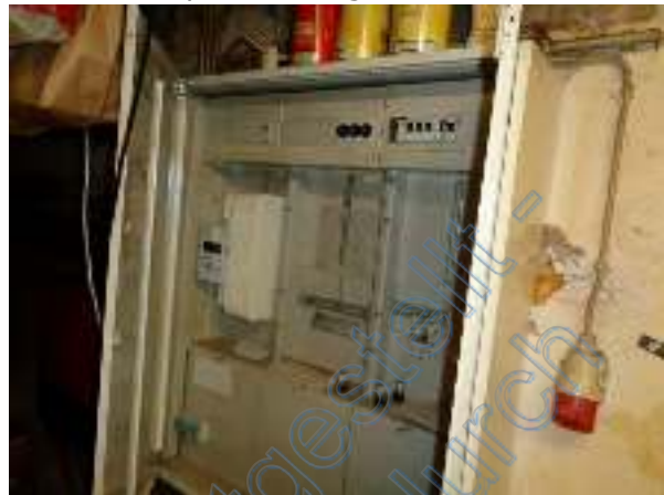
Elektro-Hauptverteilung im KG-Flur
