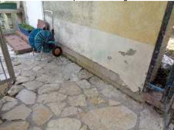
schadhafter Außenputz an Garage
