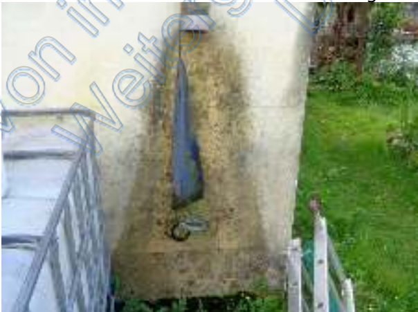
Detail fehlender Fallrohranschluss Garage
