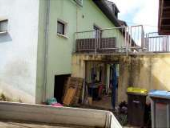
lokaler Renovierungsbedarf an Fassaden
