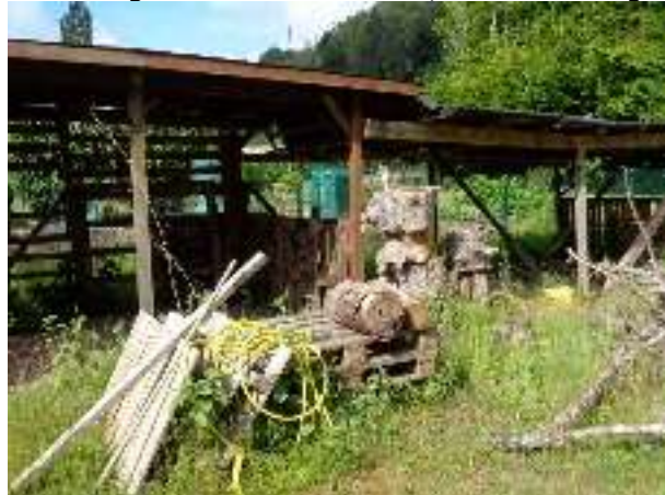
rückseitige Holz-Unterstände, teils baufällig
