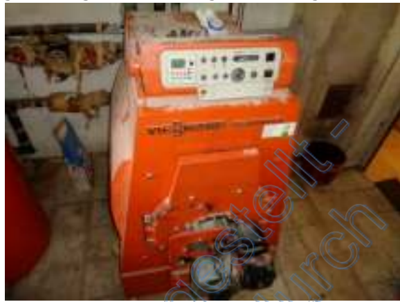
gem. Angaben Heizungssteuerung schadhaft
