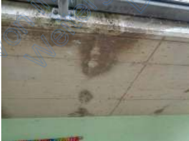
Detail Undichtigkeit im Balkon-Randbereich
