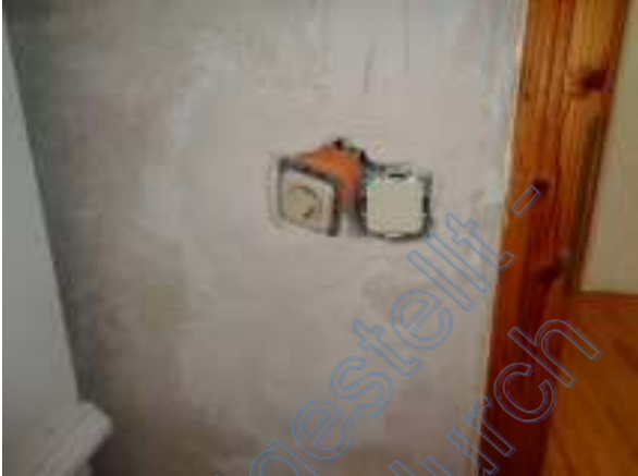
Beispiel ausstehender Fertigstellungsarbeiten
