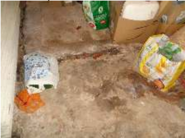
Bodenriss (zeitweise etwas Wassereintritt)
