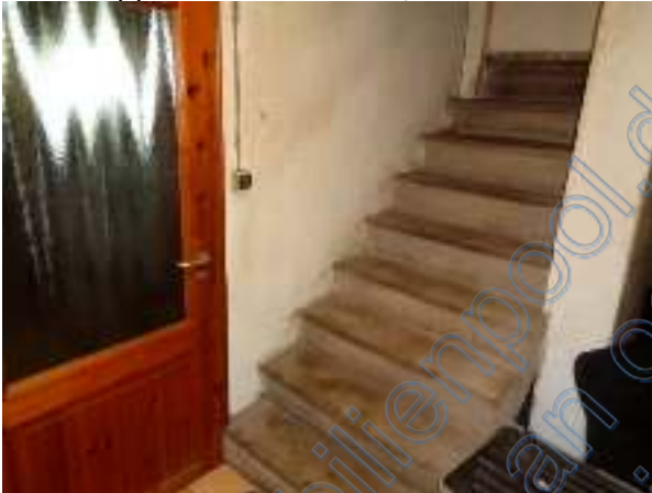
KG-Treppe ohne Handlauf / Geländer
