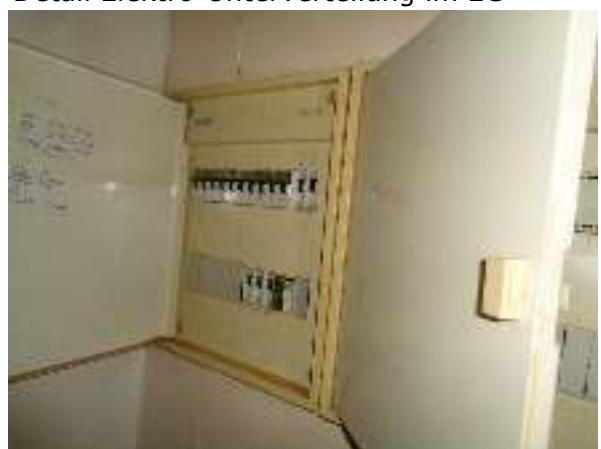
Detail Elektro-Unterverteilung im EG
