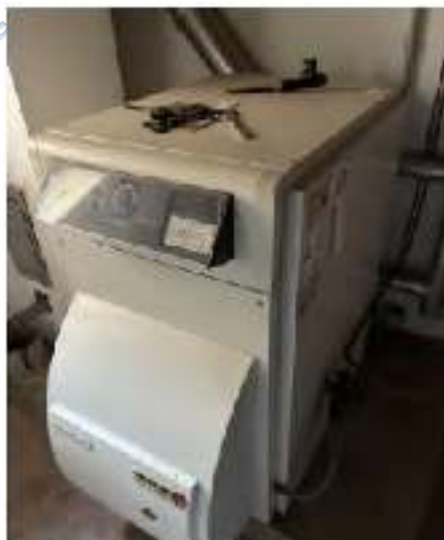
Bild 20: Heizkessel (im Scheunen-/Stallteil)
