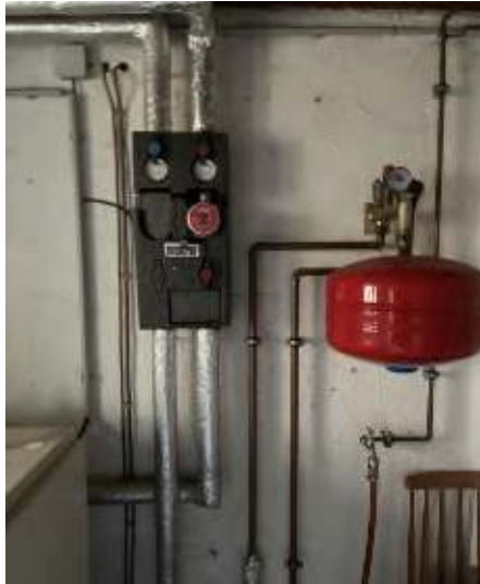
Bild 21: Heizungsanlage (im Scheunen-/Stallteil)
