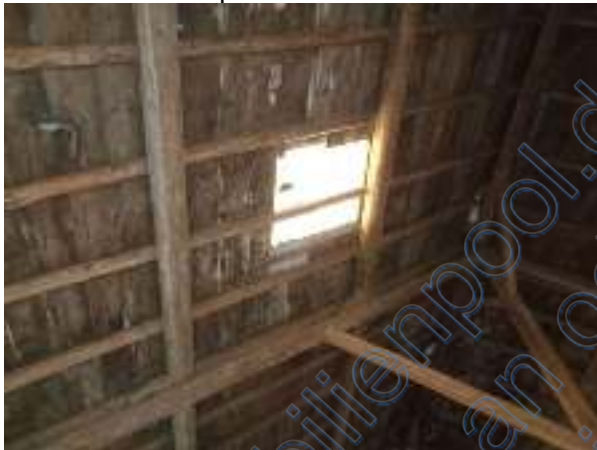
Lokale Feuchtespuren an Dachholz
