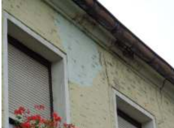
Beispiel lokaler Fassadenrisse
