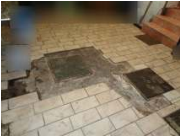
Detail Schäden Bodenfliesen
