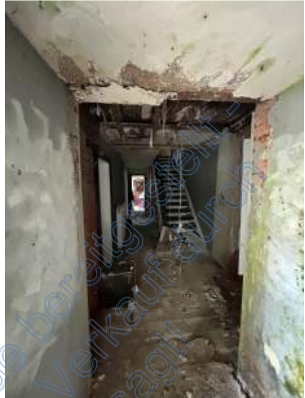
Flur EG (Wasserschaden)
