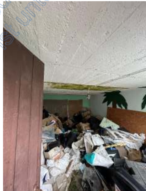
Zurückgelassenes im Schuppen (rechte Seite) Feuchtigkeitsspuren vermutl. vom Dach kommend
