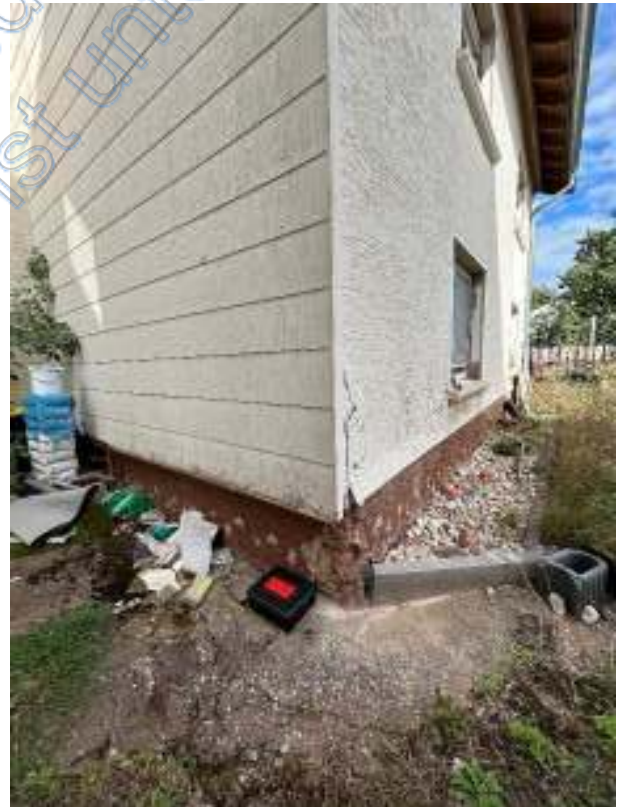
Rissbildung Fassade (Beispielbild)
