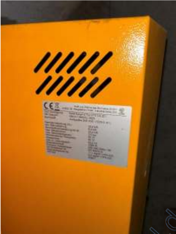
Pelletheizung aus 2020 nicht angeschlossen
