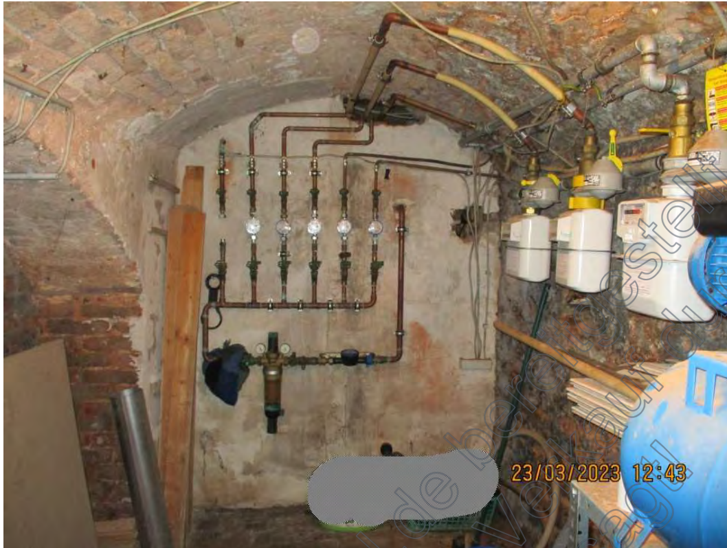
5.7 1. UG, Gaszähler der Wohnungen, Übersicht
