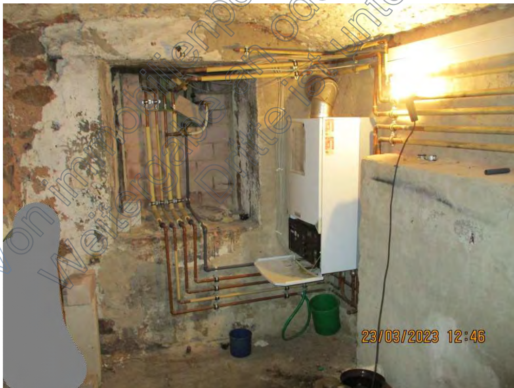
5.6 1. UG, Heiztherme des Hauses, Übersicht
