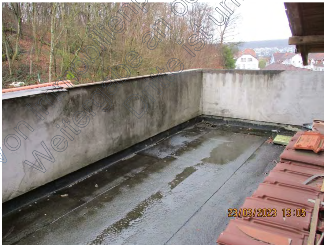
5.16 Dachterrasse der Dachgeschosswohnungen, undicht, verursacht erheblich Schäden
