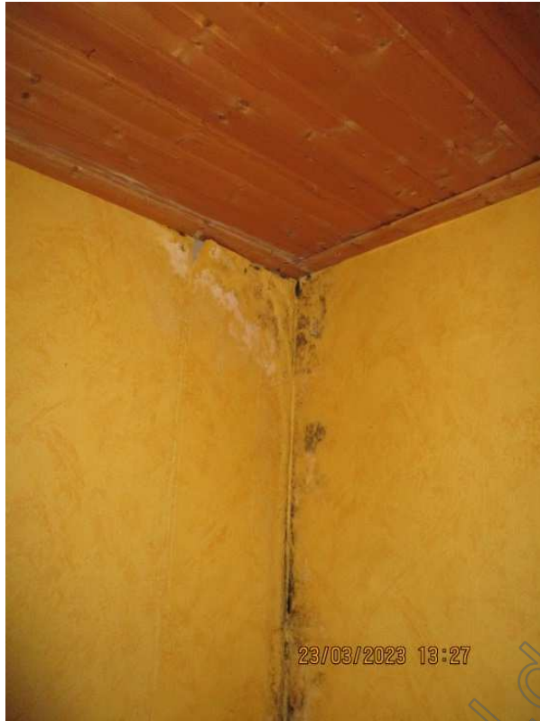
5.17 EG, Altbau, Schimmelpilz als Folge der dauernden Mauerfeuchtigkeit, Beispiel
