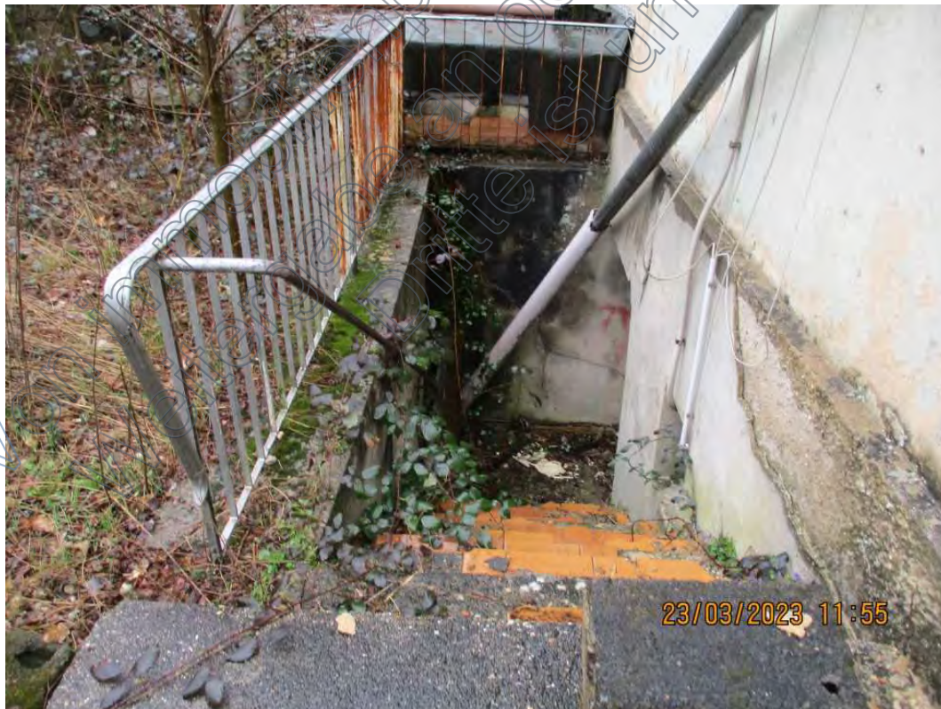
Kelleraußentreppe, erhebliche Schäden
