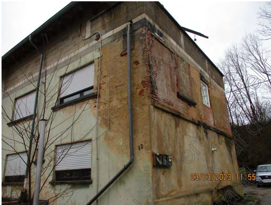
5.3 Westseite/Zufahrt, stark durchfeuchtete Hauswand, Übersicht
