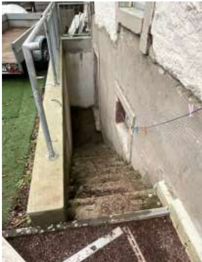
Kelleraussentreppe Süd und Fassade KG mit erheblichem Fertigstellungstau, energetische Fassadensanierung unterstellt
