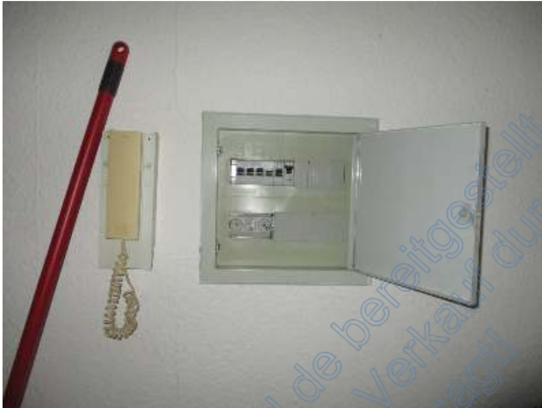
5.5 DG-Wohnung: Unterverteilung, Übersicht
