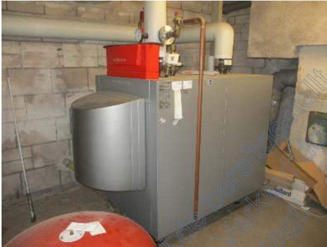
5.3 UG: Heizkessel, Übersicht
