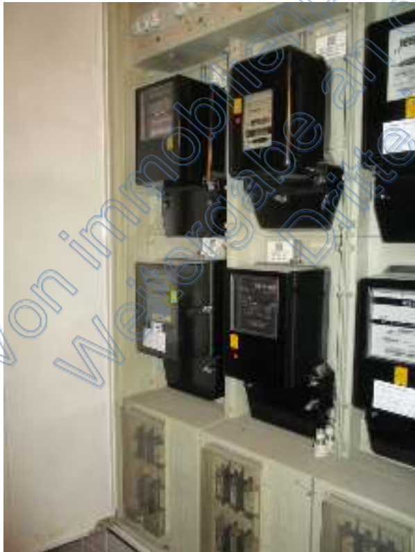
5.4 UG: Zählerschrank, Übersicht
