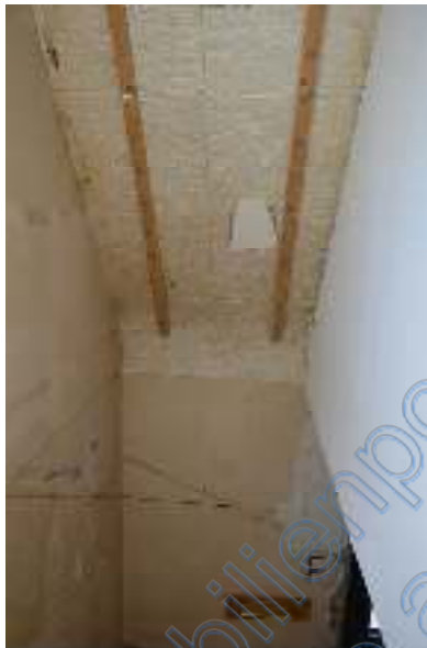
Decke im Treppenraum – nicht fertiggestellt
