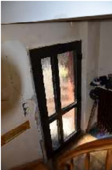
Eingangsbereich – nicht fertiggestellt
