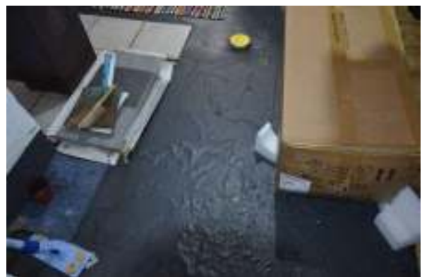
Bodenbelag in Kellergeschoss schadhaft - exemplarisch
