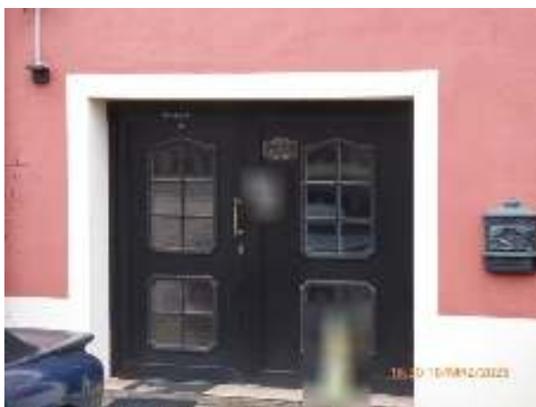
Foto 5 – Außenanlagen etc. + Unterhaltungsstau etc.
