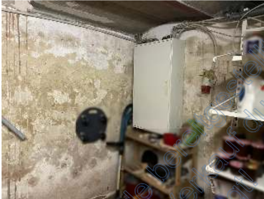
Bild 11: Beispiel für aufsteigende Mauerwerksfeuchtigkeit
