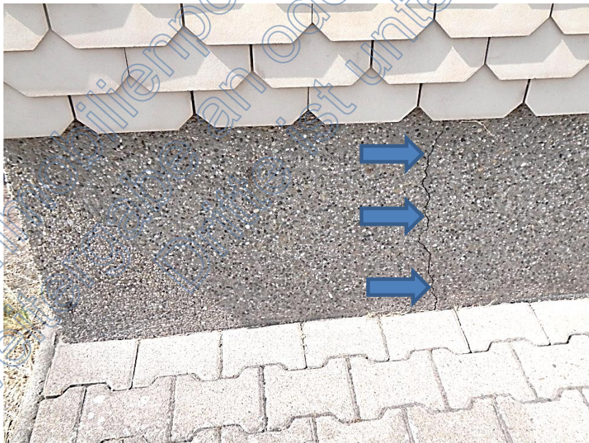
Rißbildungen Sockelbereich Süd
