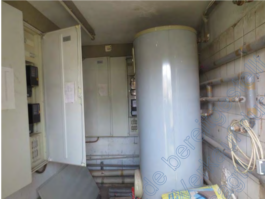
5.13 W-Wasserspeicher, Fernwärmeübergabe, Stromzähler Übersicht
