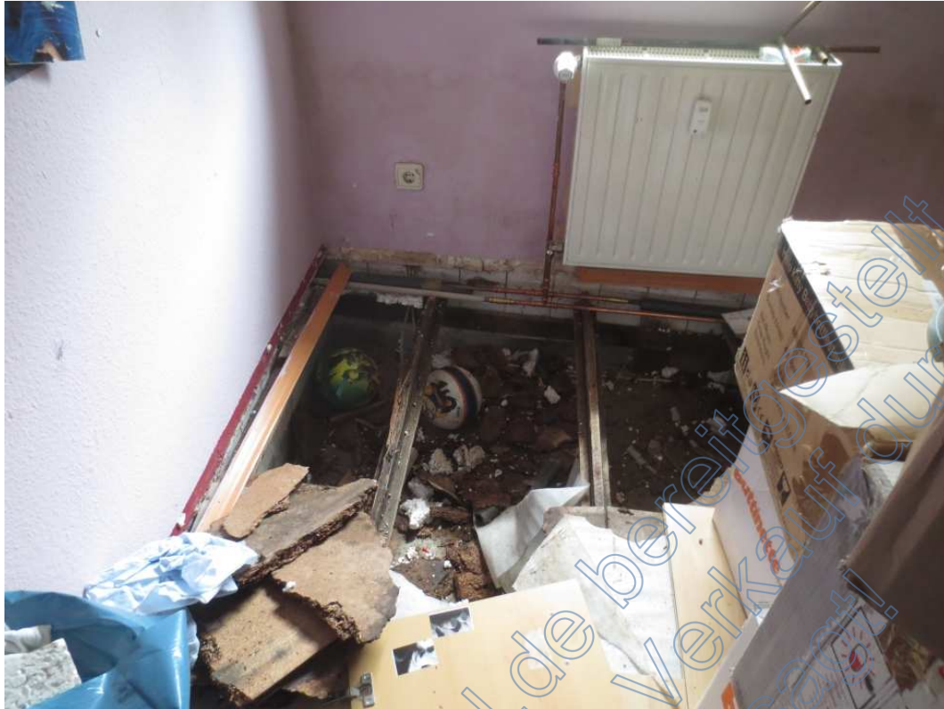
5.17 Erhebliche Mängel der Wohnung Nr. 3, Beispiel im Zimmer (wurde bereits lt. Angaben beseitigt)
