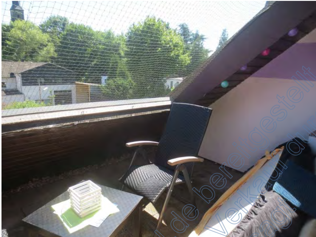
5.11 Dacheinschnitt, Schäden, Übersicht
