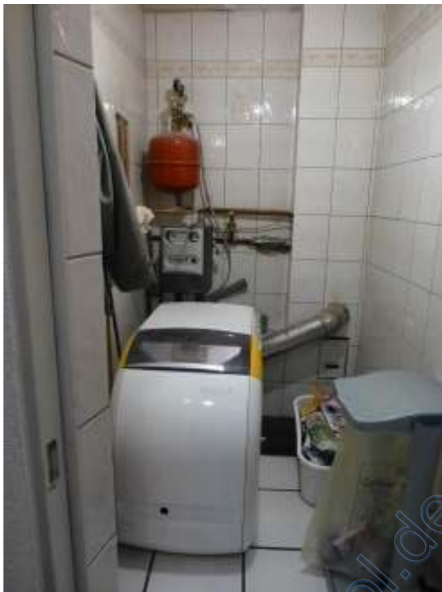
EG – Heizungsraum mit Öl-Heizungsanlage
