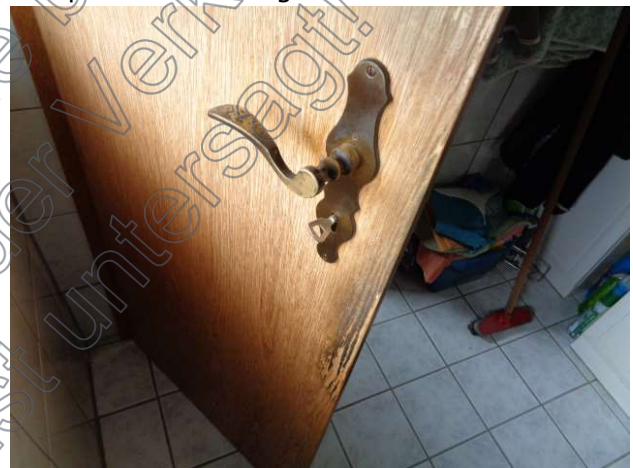
Beispiel Renovierungsbedarf Innentüren
