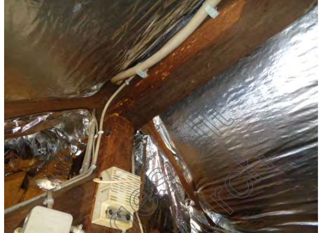
lokal alte Spuren von Holzschädlingsbefall
