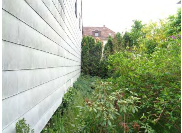
Eternitverkleidung vermutlich noch asbesthaltig
