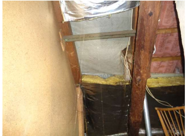
lokal fehlende Dachdämmung (SAT-Bereich)
