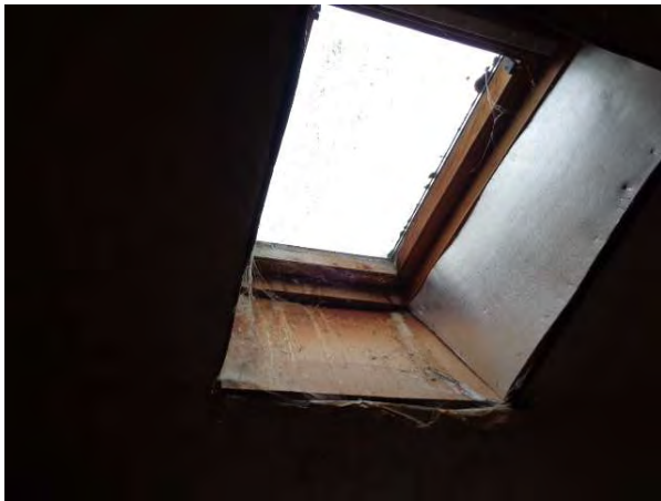
Altes Dachfenster mit Feuchteschäden
