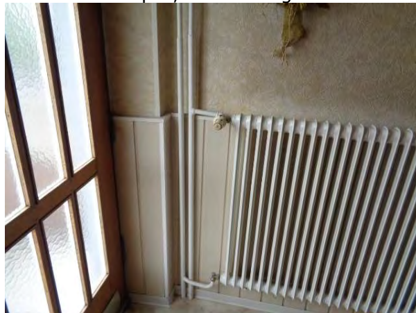
Gliederheizkörper; Verrohrung über Putz
