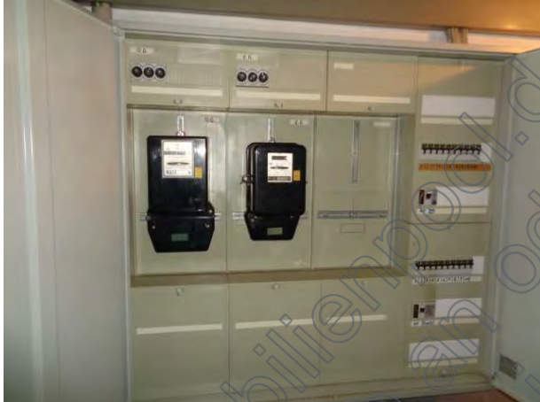
Elektro-Hauptverteilung ca. 1996 erneuert
