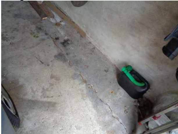
Garagen-Estrichboden mit Rissen
