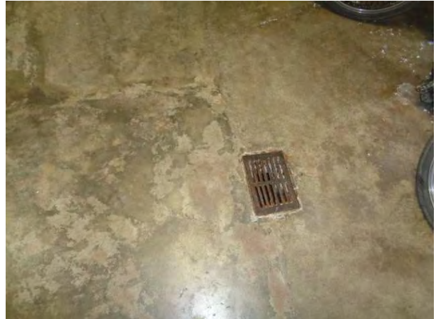
roher Betonestrich mit Riss-Schäden
