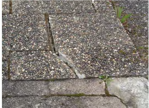
Beispiel lokale Schäden Außenbefestigungen
