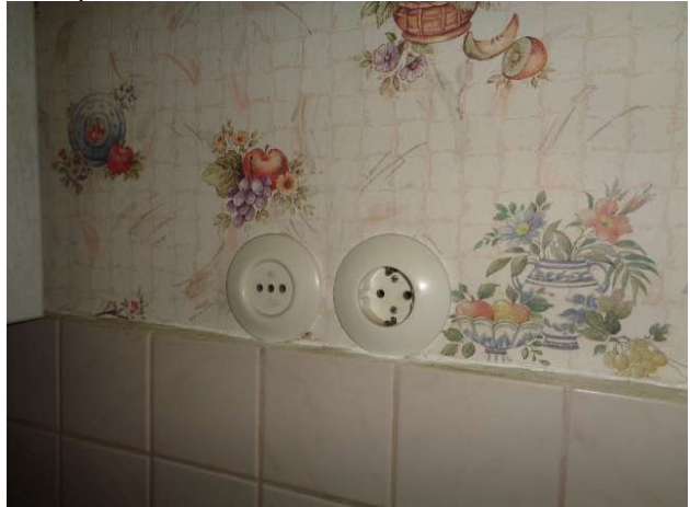
Beispiel alte Elektro-Installationen
