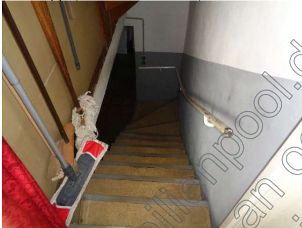
KG-Treppe; Höhe lokal nur 1,78m
