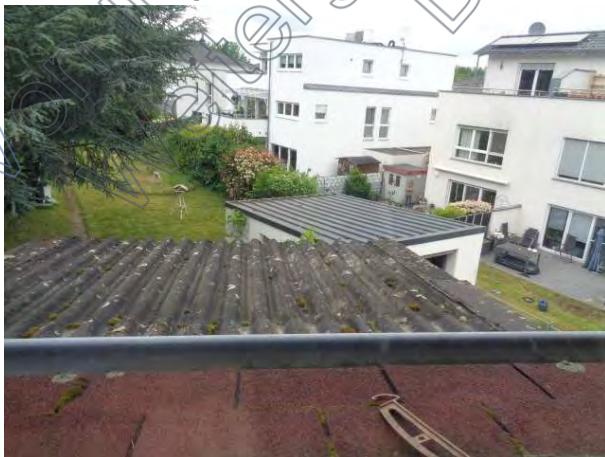
Eternitdeckung Anbau vermutlich asbesthaltig DG-Küche
