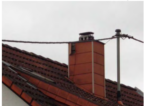
Detail fehlende Platte Kaminverkleidung
