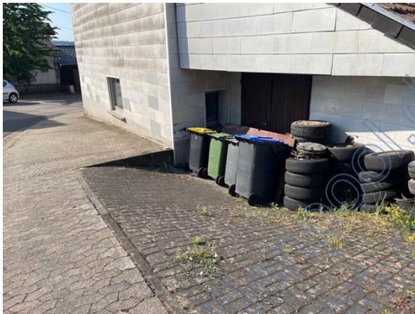
Setzungen Außenanlage, ungünstige Zufahrt
