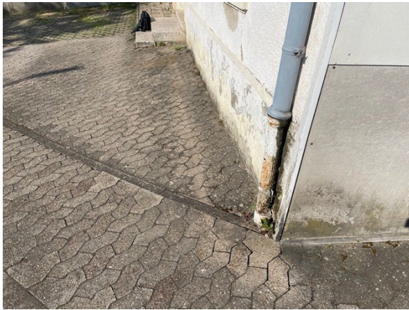
Putz- und Feuchteschäden
