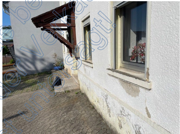
Putz- und Feuchteschäden
