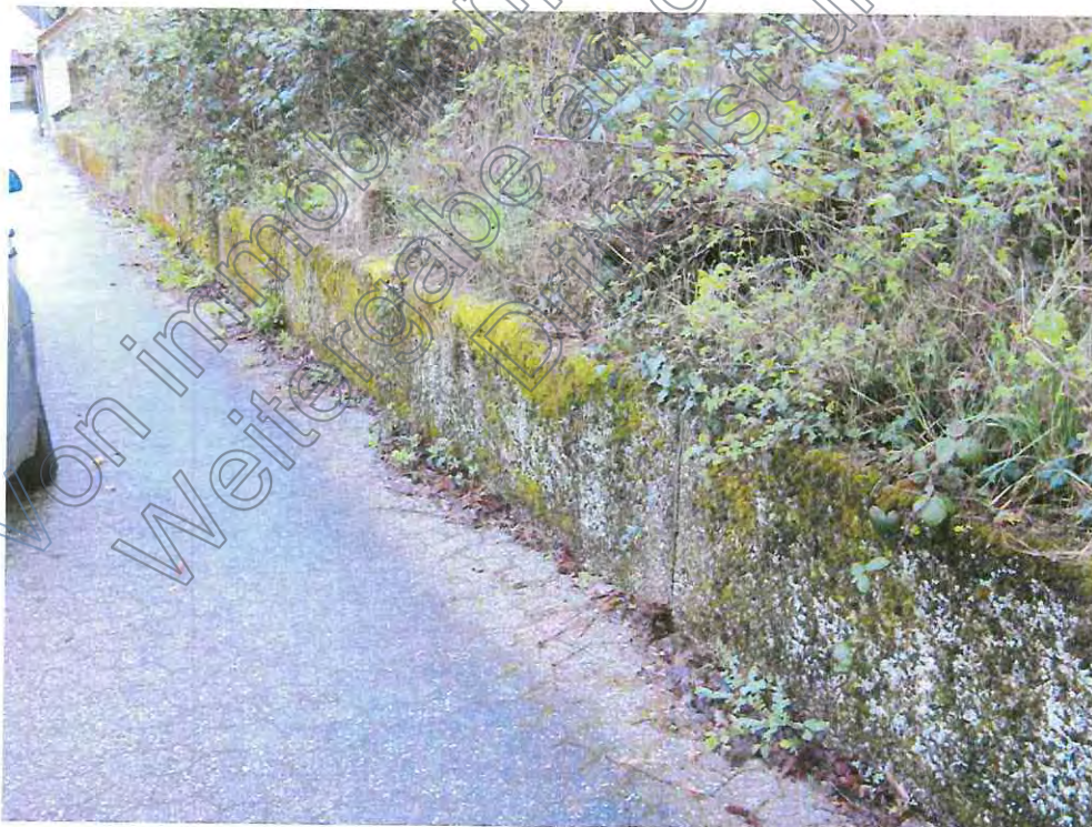
Stützmauer (ohne Wert)
