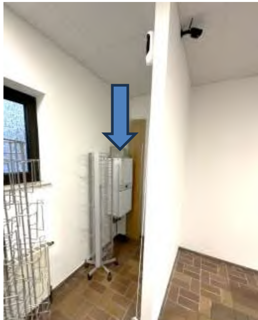
Eigene Gastherme, defekt, unterstellter Austausch
