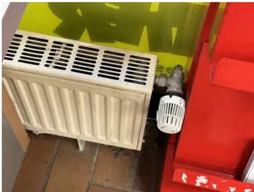
Heizkörper an Schaufensteranlage
