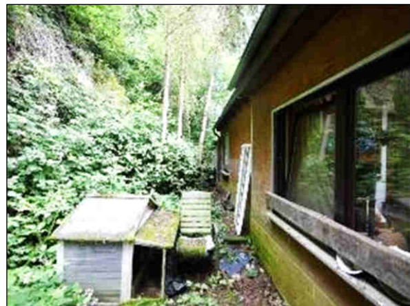
Bild 32: nicht genehmigte Anbauten an der Gebäuderückseite
